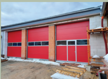
Výjezdové garáže hasičské zbrojnice mají nová vrata
