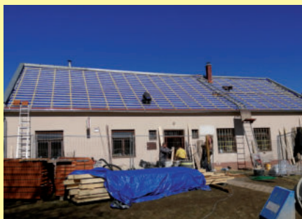
Klubovny v Panském dvoře budou mít novou střechu
