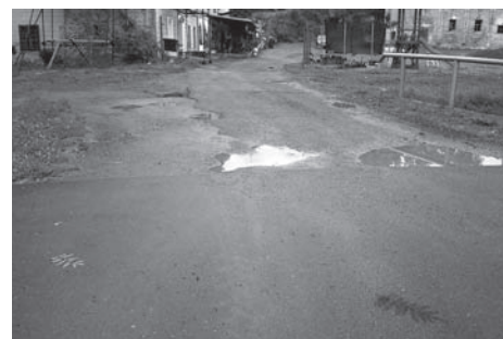
Část místní komunikace u areálu bývalého JZD před opravou
