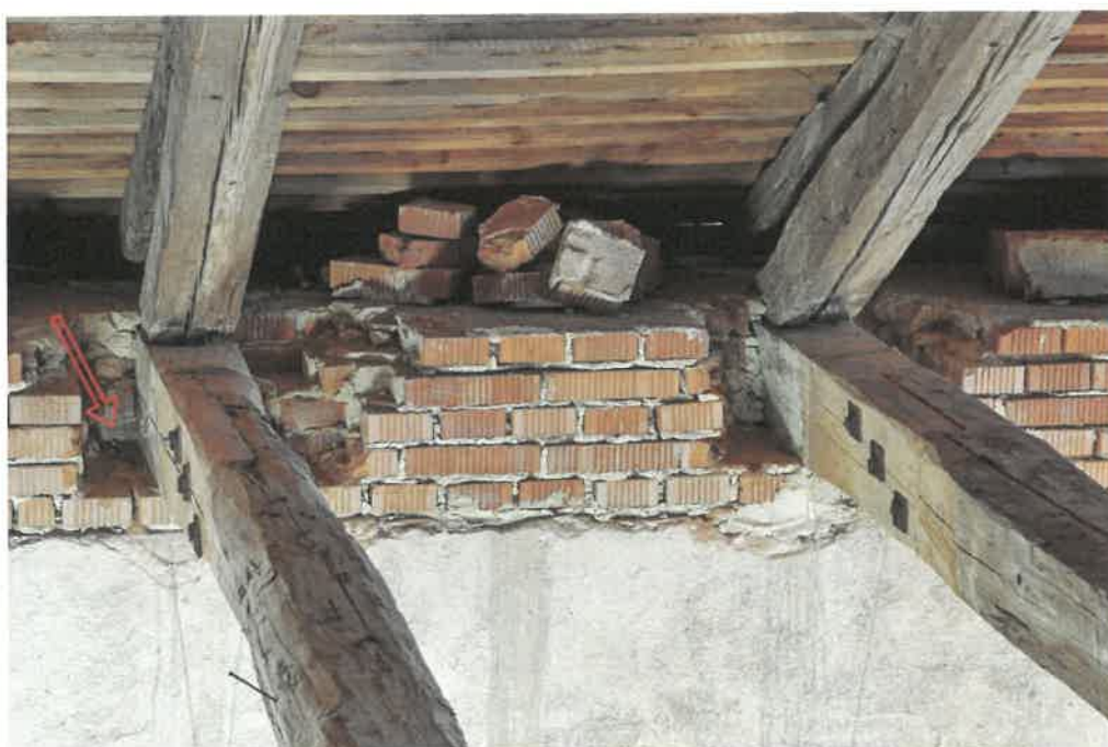
26. Detail odsekání zhlaví vazných trámů. Šípkou vyznačena poloha zcela zazděné pozednice, instalované pod vaznými trámy
