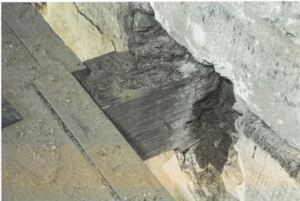
19. Zhlaví stropního trámu nad 2. NP při západní obv. zdi, silně poškozené dřevomorkou a červotočem
