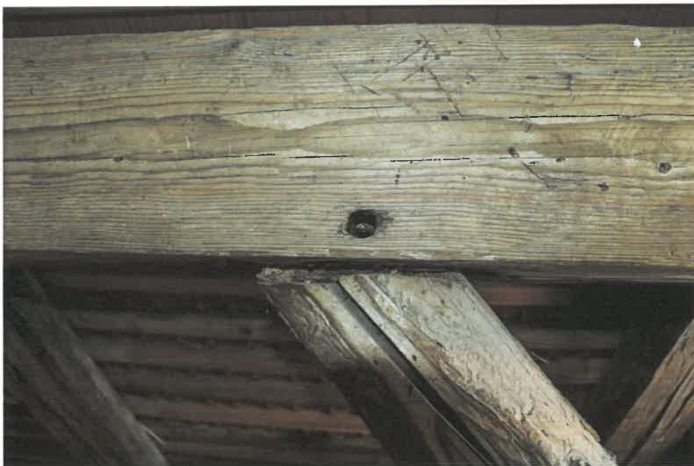
31. Chybějící zajišťovací kolký čepů pásků v plných vazbách krovu. Čep je částečně uvolněný
