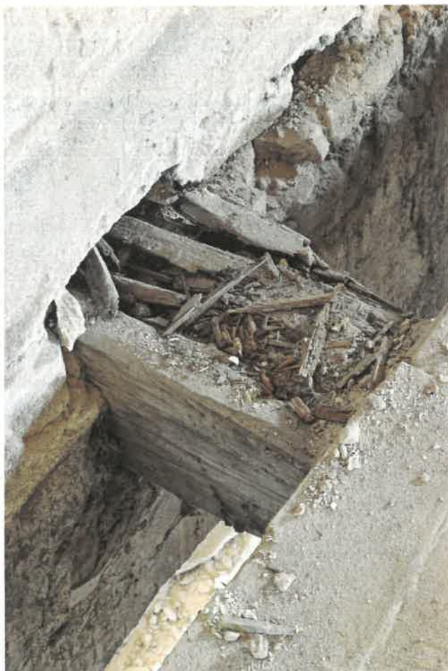
12. Zhlaví stropního trámu nad 1. NP při západní obv. zdi, silně poškozené dřevomorkou a červotočem
