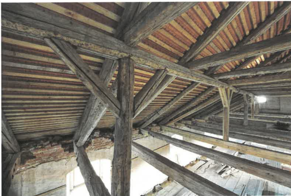
25. Konce vazných trámů zazděné do koruny zdiva z nových plných cihel a znovu vysekané ze zazdění v rámci průzkumu
