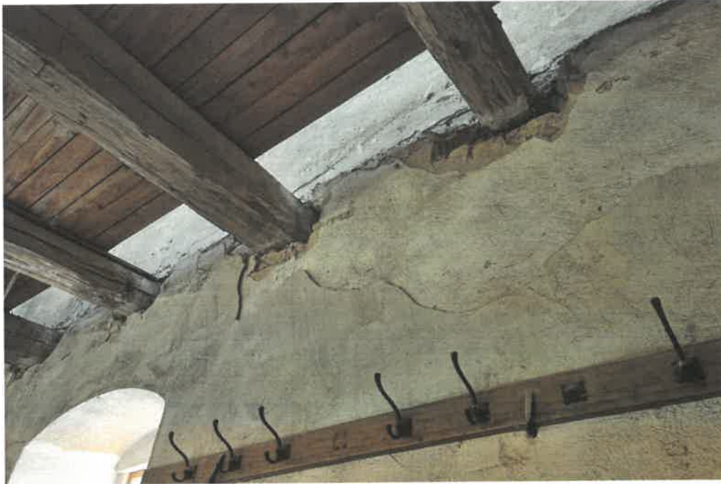
15. Zhlaví stropních trámů nad 2. NP, vysekaná ze zadržení v rámci průzkumu. Pod nimi patné vrstvení omítek z různých stavebních oprav interiéru.
