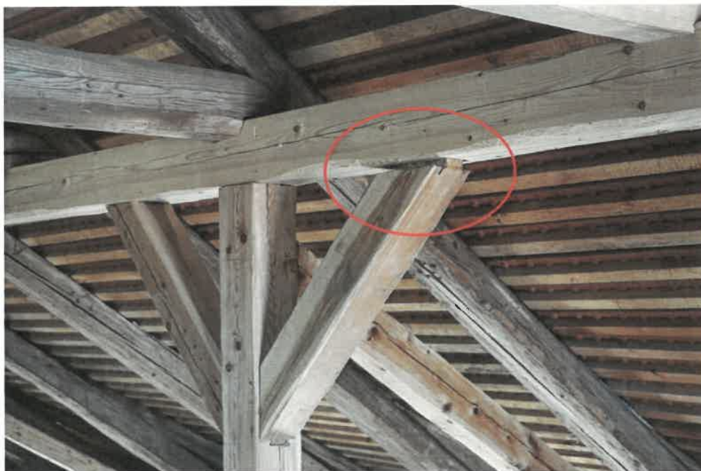
32. Nový pásek s čepovým spojem s vaznicí, nezajištěným kolkem. Nebezpečí uvolnění spoje a pádu pásku do prostoru 3. NP
