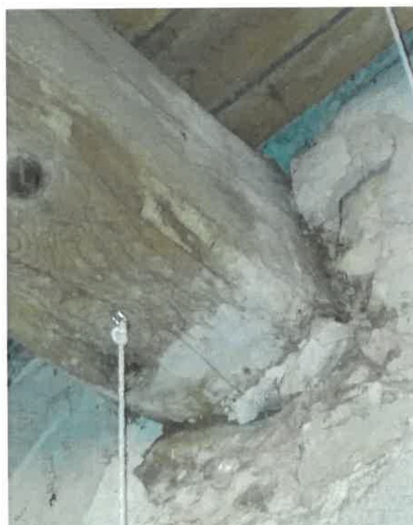
napadené zhlaví stropnic 1.NP
