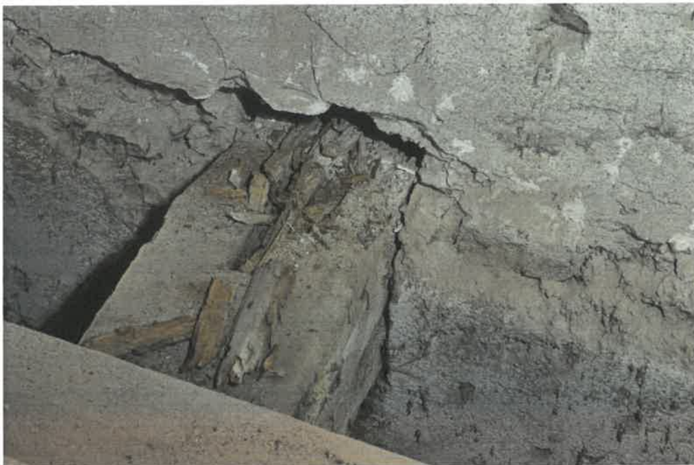
11. Zhlaví stropního trámu nad 1. NP při východní obv. zdi, silně poškozené dřevomorkou a červotočem
