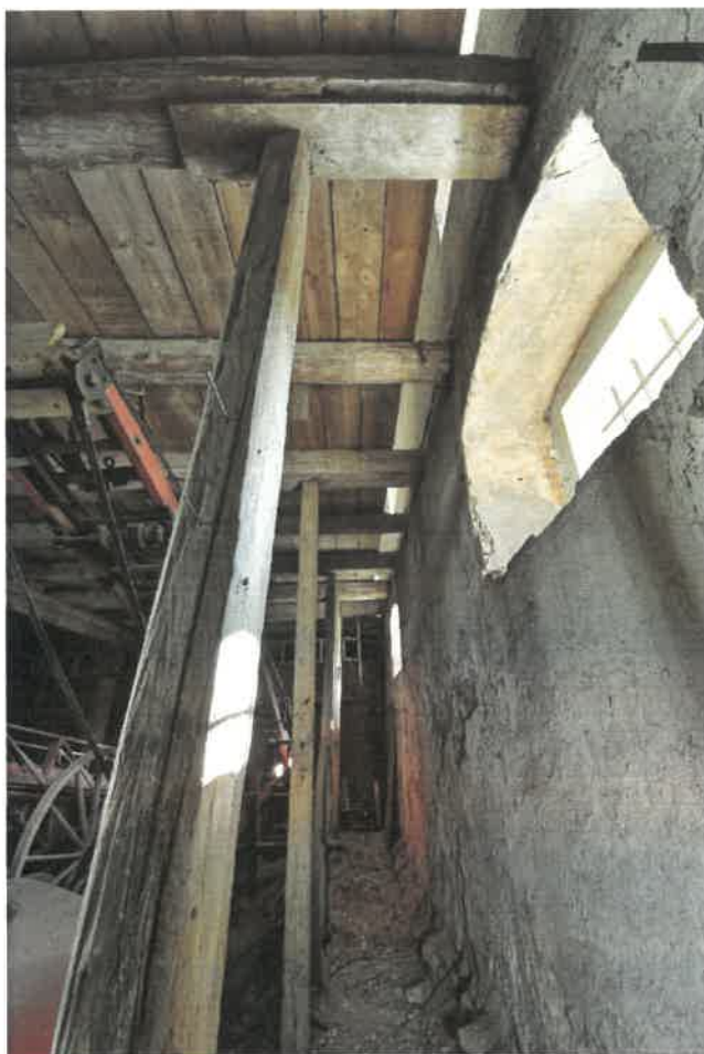
7. Provizorně podepřené havarijní stropní trámy nad 1. NP u západní obvodové zdi.
