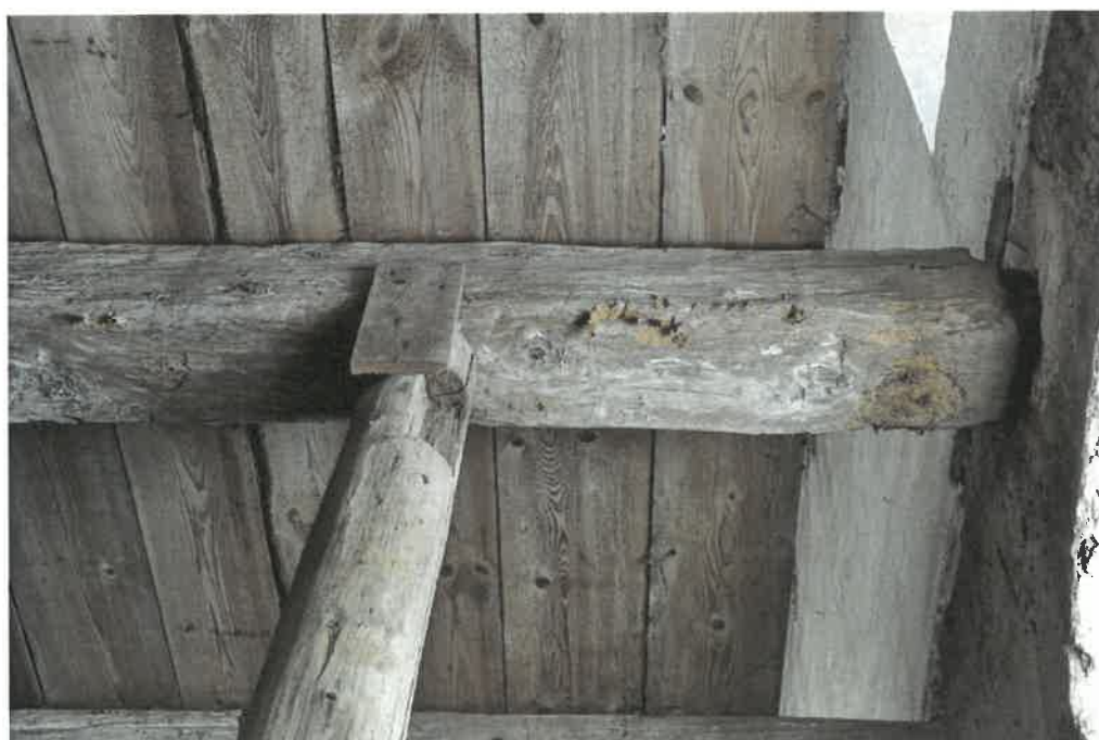
8. Konec stropního trámu nad 1. NP u západní obvodové zdi, silně napadený dřevomorkou (ve zdi) a červotočem.
