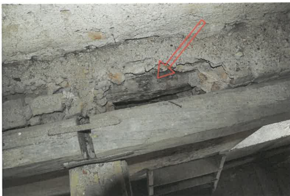
30. Nález dubového trámku , plně zazděného za krajním stropním trámem do jižní obvodové zdi. Patrně se jedná o dřevěnou zední kleštinu
