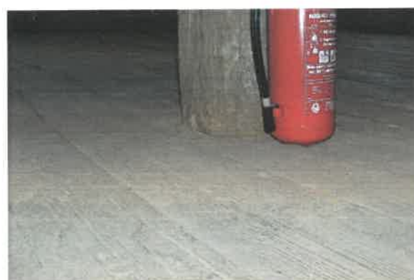
propadená podlahy u sloupu ve 2.NP
