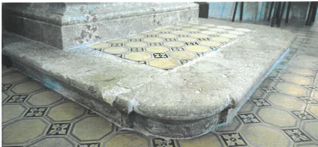
Obr.3. Typická poškození: lokální poškození profilace stupňů.
