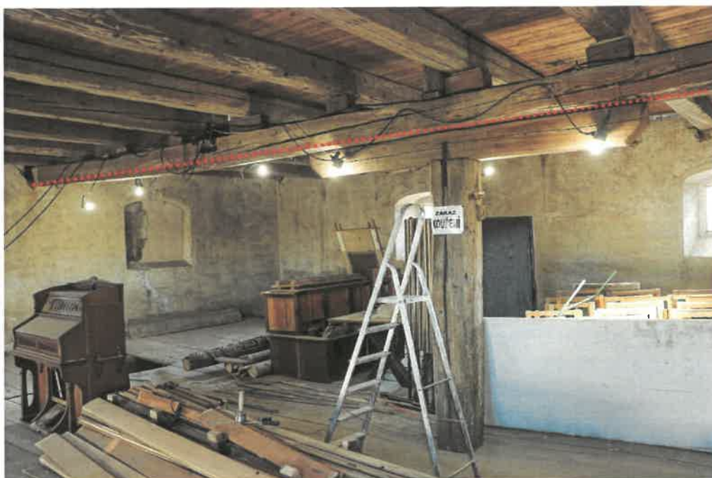
20. Výrazný průhyb podélného průvlaku způsobený poklesem jižního sloupu
