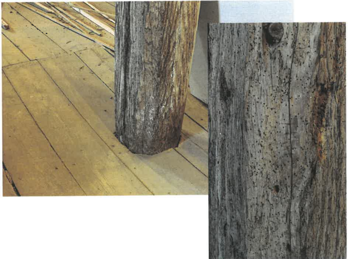
16. Jižní sloup ve 2. NP silně poškozený červotočem. Vpravo detail povrchu sloupu s výletovými otvory
