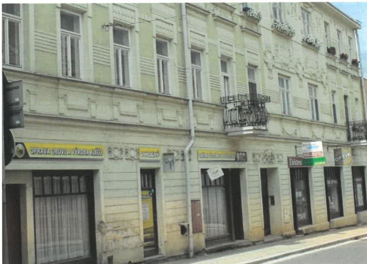
Průčelí městského domu čp. 71 před obnovou v r. 2017 a po obnově v r. 2018:
