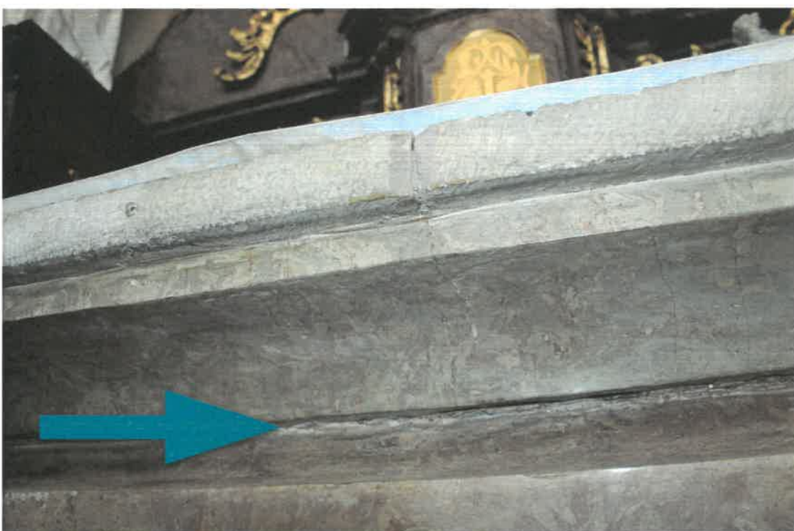
Restaurátorský průzkum - oltář sv. Kříže - nahoře celkový pohled, dole trhlina vpředu v místě spáry a oprava prskliny kopírující blok kamene
