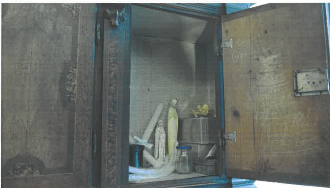
Vnitřní prostor skříňky upravené tapetováním, pohled na vnitřní stranu poškozených dveří
