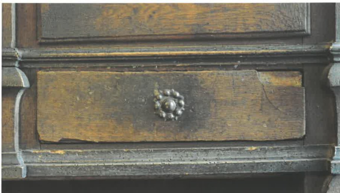
Detailní pohled na poškození čela šuplíku
