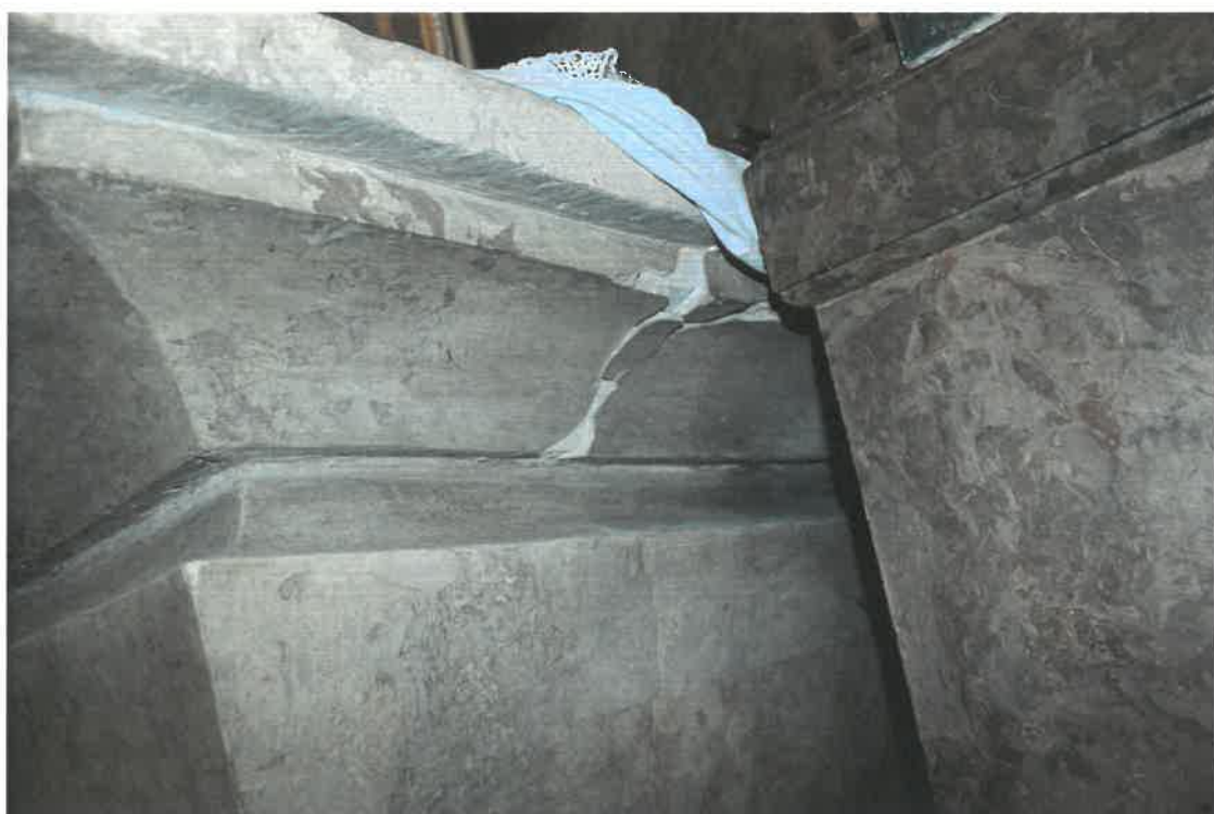
Restaurátorský průzkum - oltář sv. Mikuláše Tolentinského - nahoře praskliny pod spárou mezi kamennými bloky, dole poškozený mramor v místě spáry.
