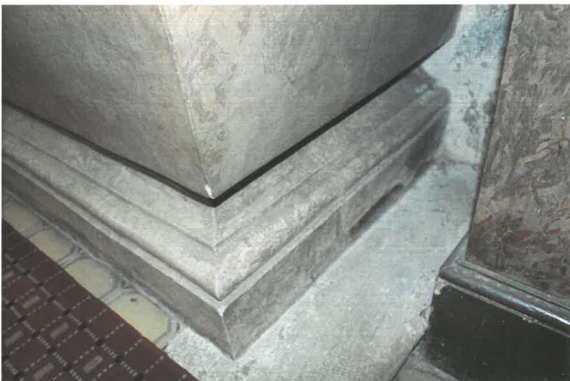
Restaurátorský průzkum - oltář Křtu sv. Augustina - nahoře levý bok, dole sokl vpravo s opravami
