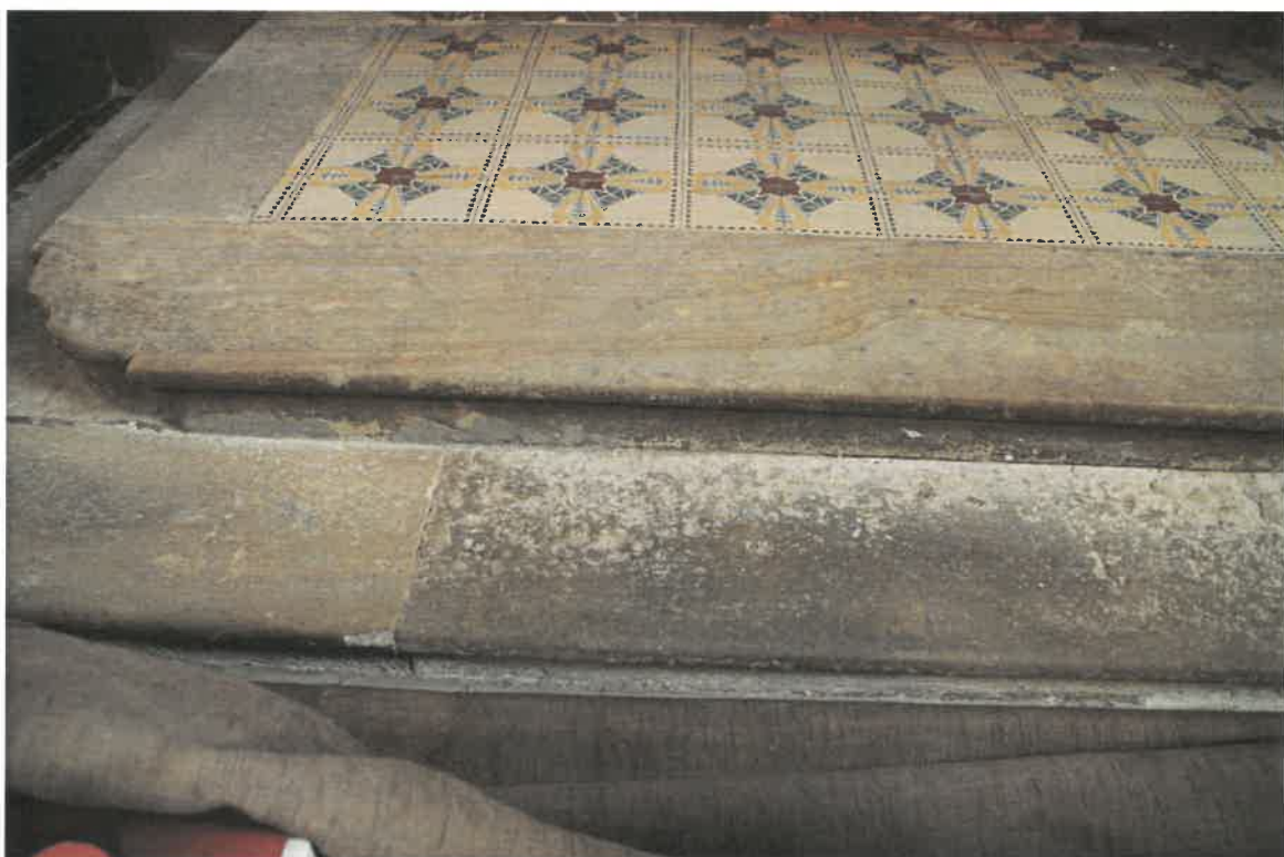
Nahoře větší otluky a dožilé spárování. Dole erozivní poškození prvního schodu zředu.
