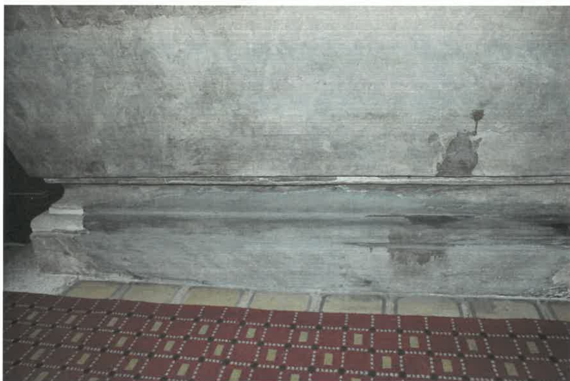
Restaurátorský průzkum - oltář Nanebevzetí P. Marie - nahoře prasklina sv místě spojených kamenných bloků, dole cementový doplněk soklové části zředu
