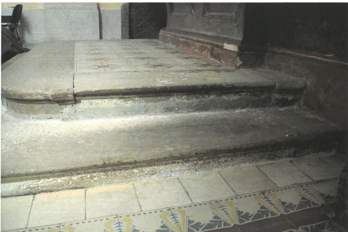
Nahoře pohled na menzu a schodišťové stupně s podestou. dole pohled z pravého boku s viditelnou opravou cementem.
