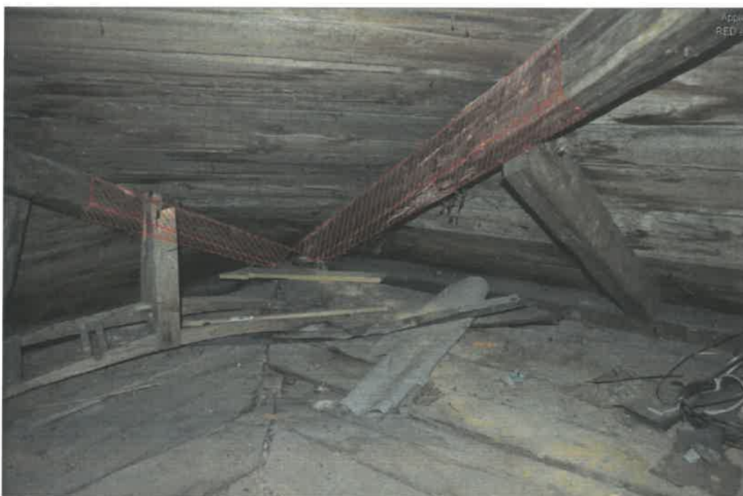
Obr. 5 Vyznačené degradované prvky v detailu spodní části konstrukce – námětky.
