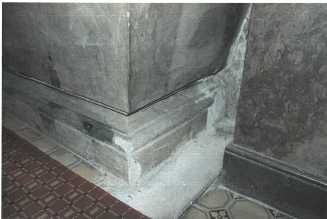
Restaurátorský průzkum - oltář Nanebevzetí P. Marie - nahoře celkový pohled, dole poškozená levá strana soklu
