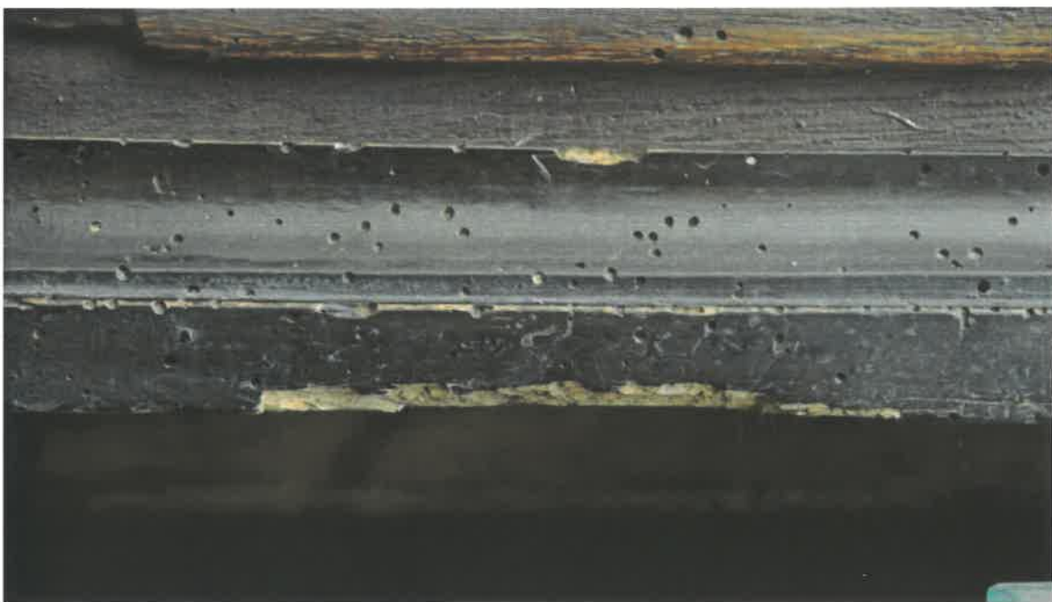
Detailní pohled na lištování rozrušené dřevokaznými škůdci
