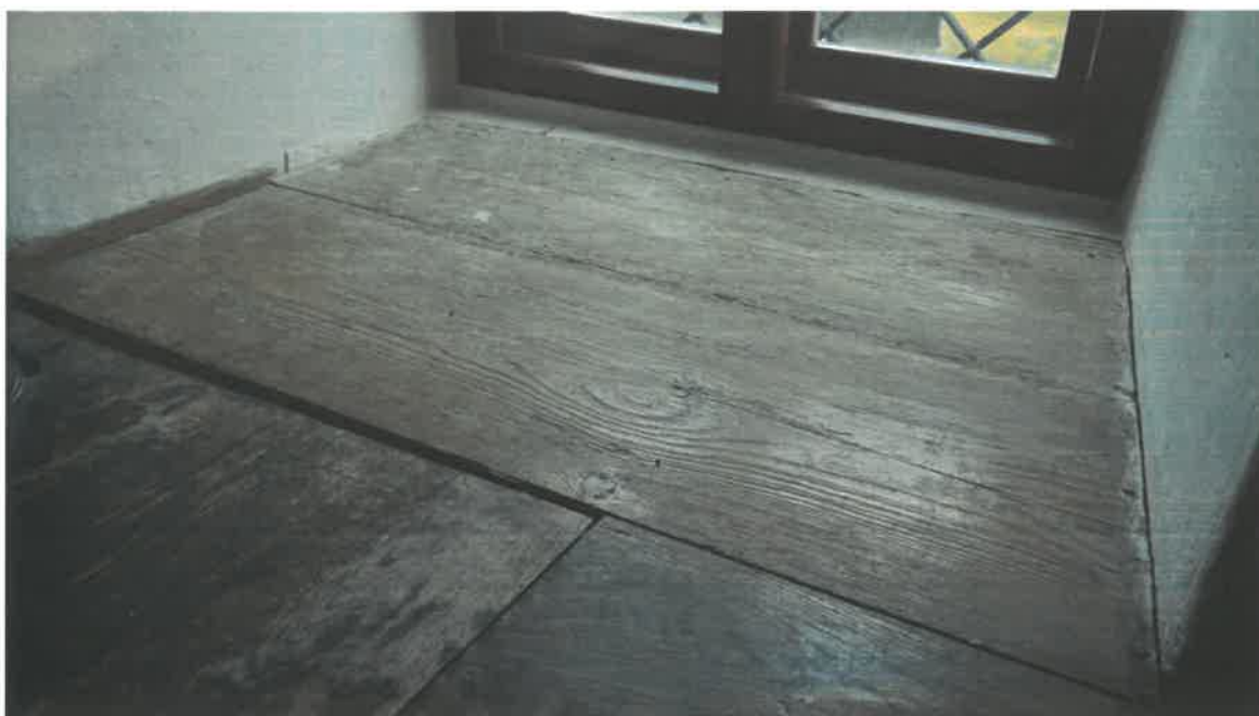
Rozeschnutí navazujících spáravek – pultová část u oken
