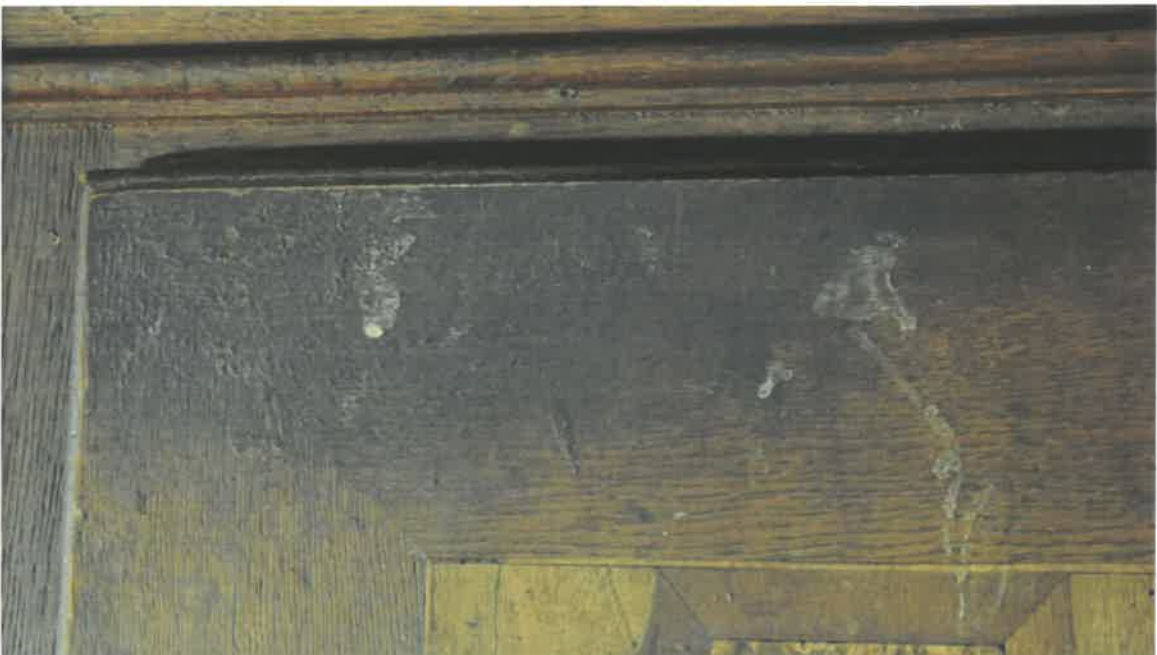
Detail poškození a opotřebení povrchové úpravy
