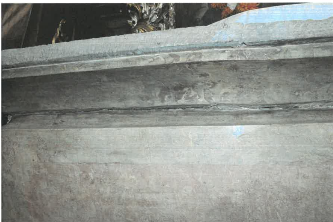
Restaurátorský průzkum - oltář P. Marie Lurdské - nahoře celkový pohled, dole horizontální prasklina kopírující kamenný blok horní desky
