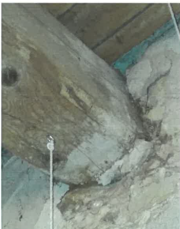
napadené zhlaví stropnic 1.NP
