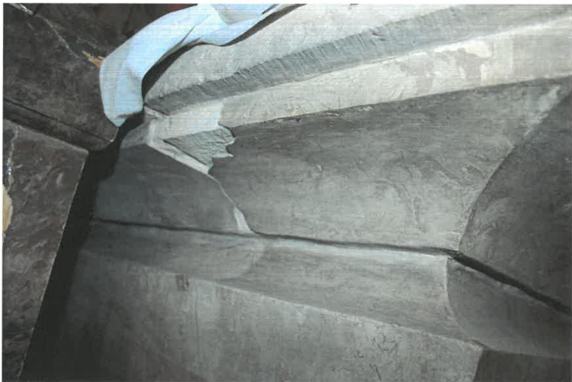
Restaurátorský průzkum - oltář sv. Mikuláše Tolentinského - nahoře celkový pohled, dole poškození levého boku s viditelnou spárou mezi kamennými bloky.
