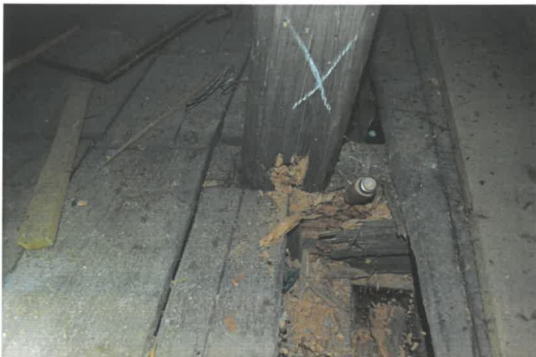
Obr. 9 Poškození vazného trámu dřevokaznou houbou ( Gloeophyllum sepiarium )
