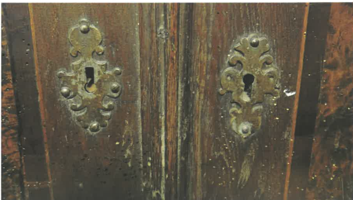
Detailní pohled na poškození klíčových štítků
