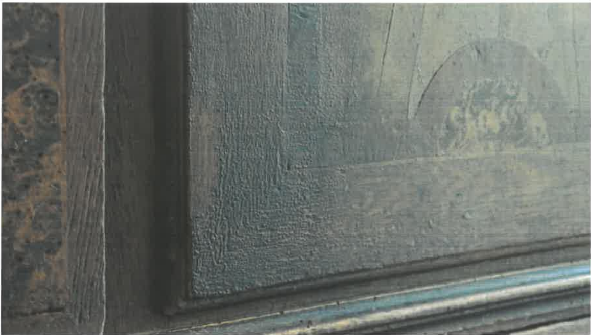
Detail degradace povrchové úpravy
