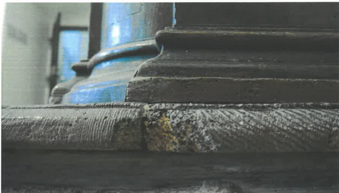
Detailní pohled na stupňovitý podstavec (podestu) – degradace dřevní hmoty vlivem dřevokazných škůdců
