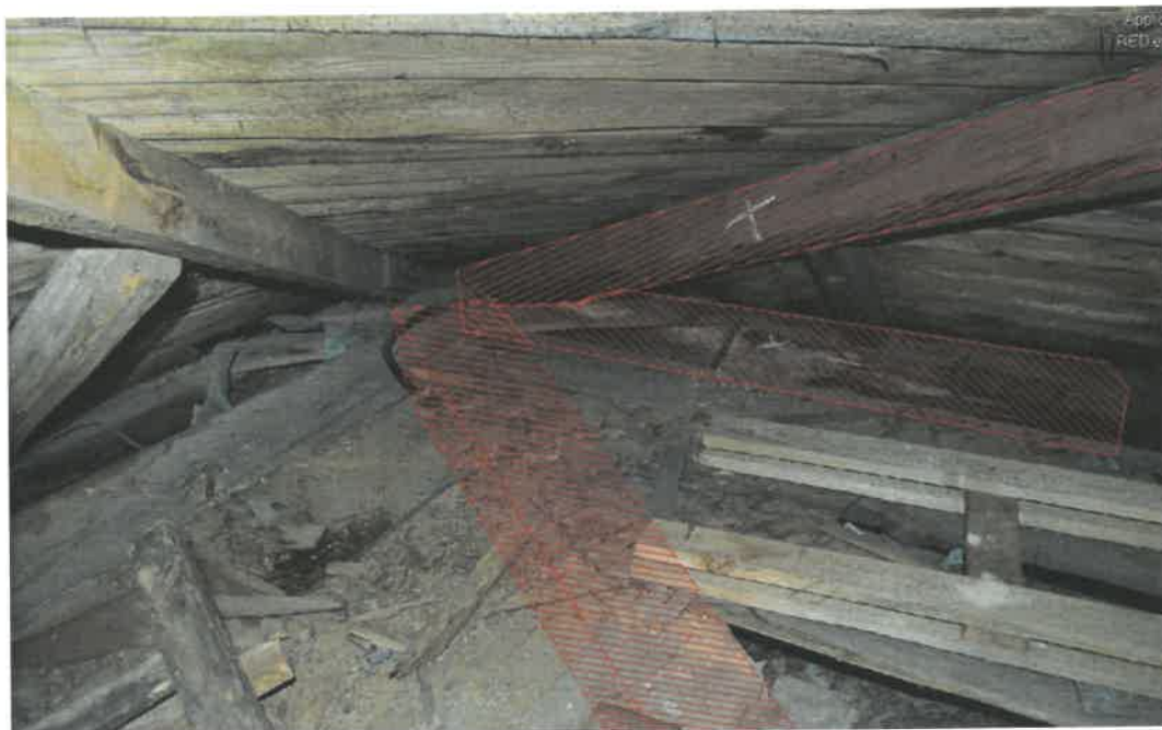
Obr. 4 Vyznačené degradované prvky v detailu spodní části konstrukce – vazný trám, pozednice a námětek.
