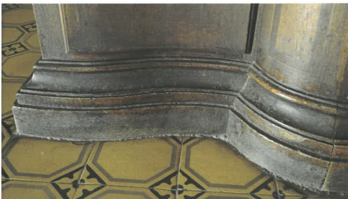
Detailní pohled na sokl – povrchová úprava poškozená běžným používáním
