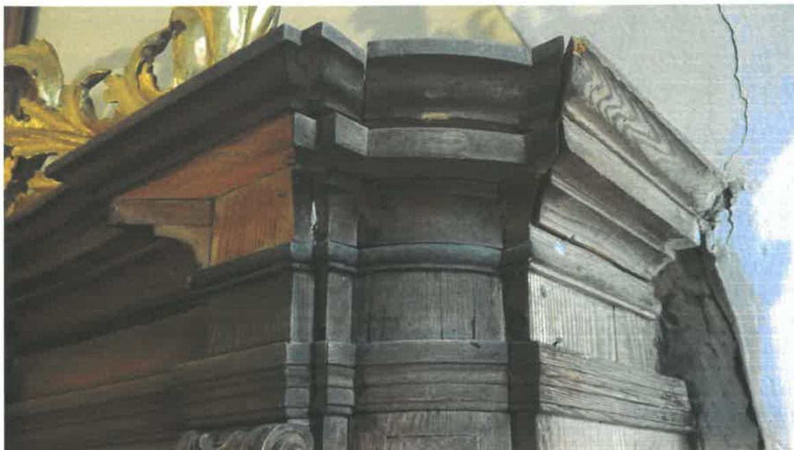
Poškozené lištování korunní římsy vlivem degradace kostního klišu
