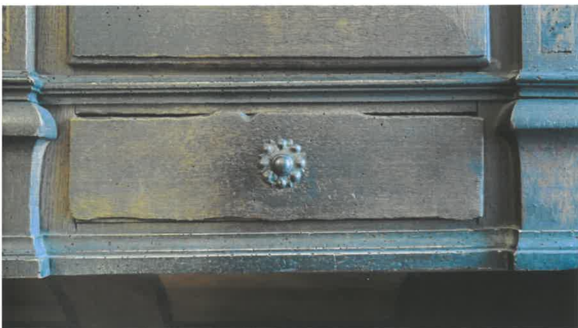
Detailní pohled na poškození čela šuplíku
