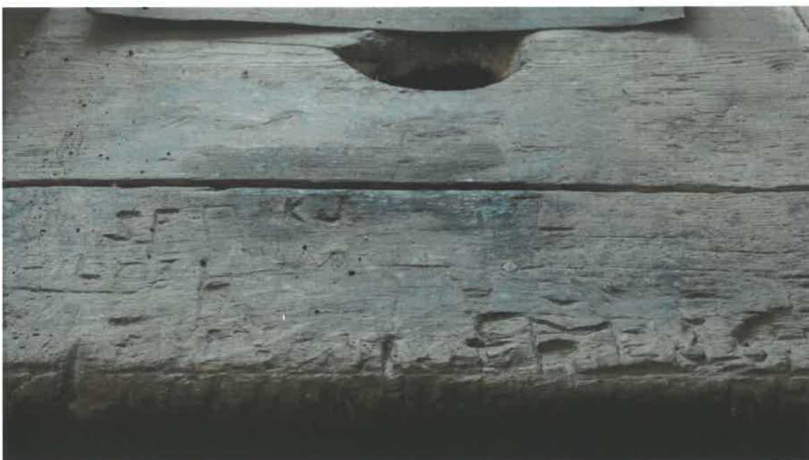
Detailní pohled na poškození pultové části u oken
