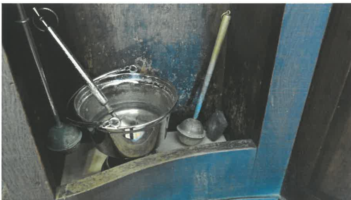
Detailní pohled na poškození vnitřního prostoru niky využívané pro liturgické předměty
