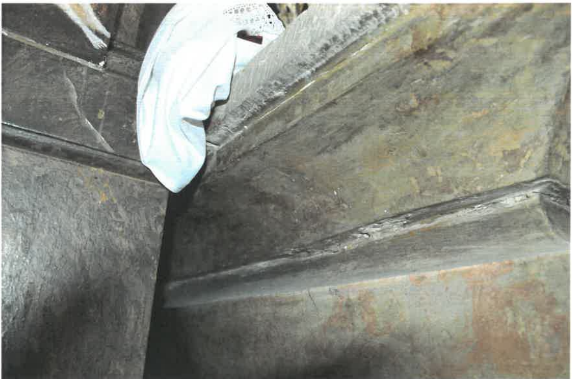
Restaurátorský průzkum - oltář P. Marie Lurdské - nahoře oprava levého boku soklu, dole viditelná oprava středové části a horizontální praskliny
