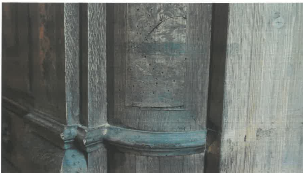
Poškození a degradace dřevní hmoty, patrné výletové otvory dřevokazných škůdců
