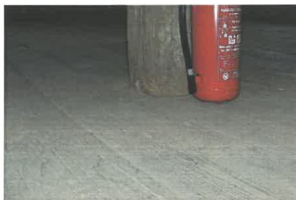
propadená podlahy u sloupu ve 2.NP
