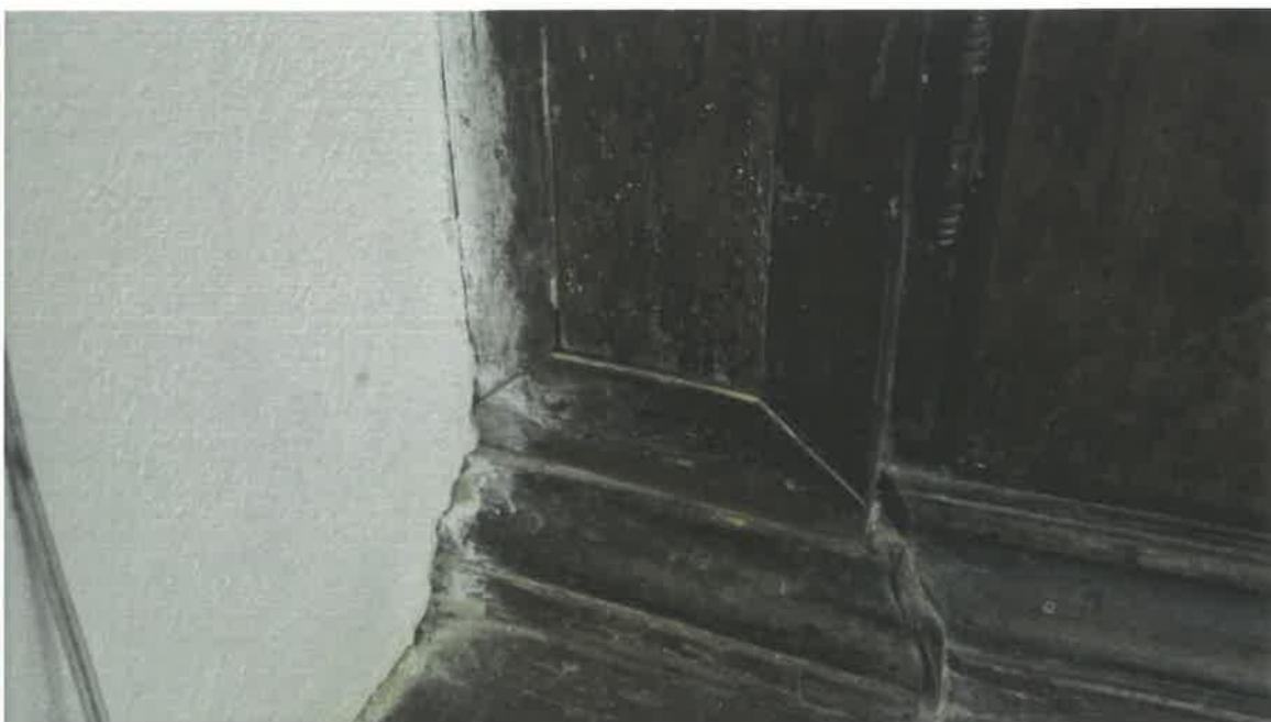
Detailní pohled na soklové lištování – poškození povrchové úpravy
