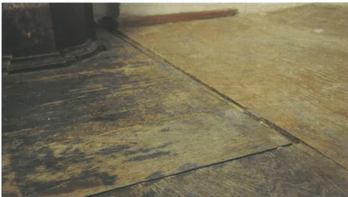
Detailní pohled na rozeschnutí navazujících spáravek
