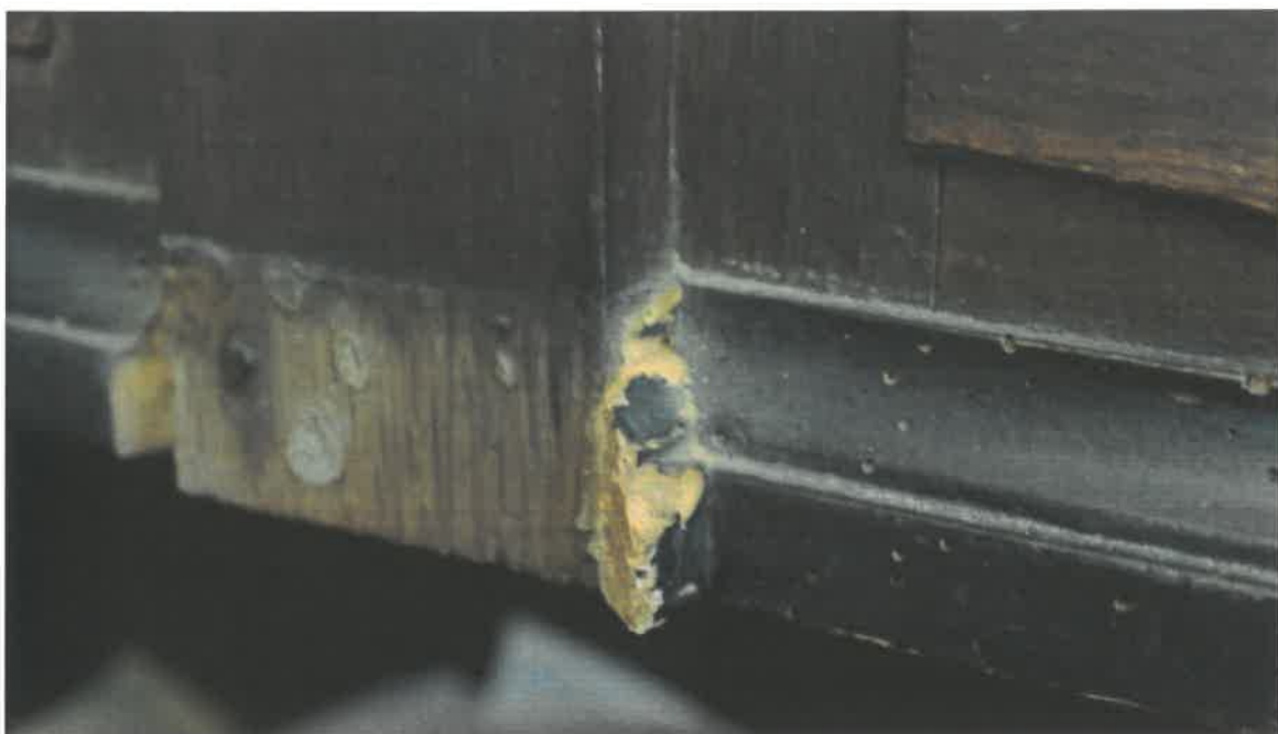
Detailní pohled na lištování rozrušené dřevokaznými škůdci
