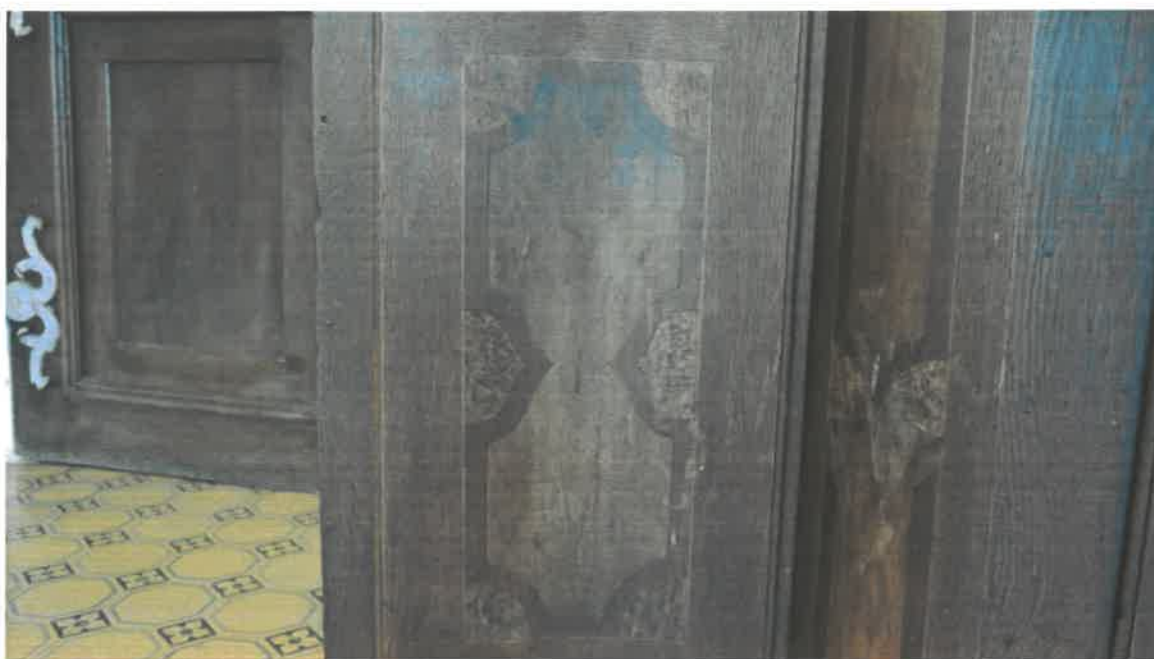
Detail poškození a opotřebení povrchové úpravy, povrchová úprava lokálně absentuje
