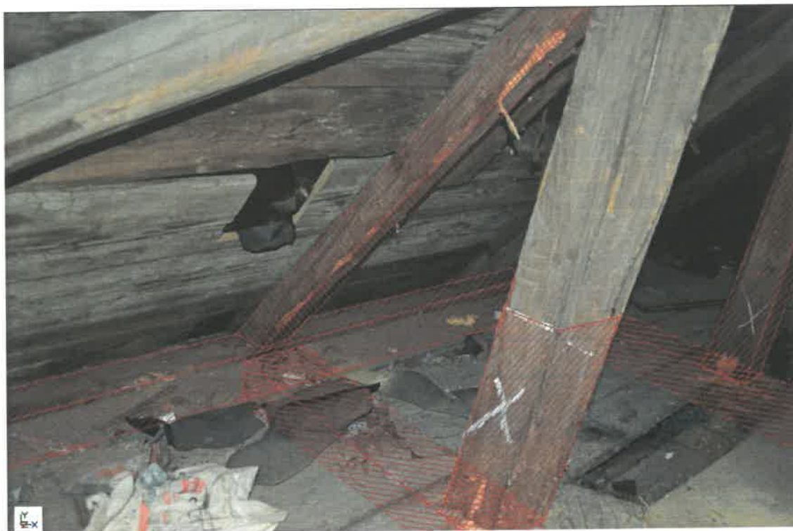
Obr. 3 Vyznačené degradované prvky v detailu spodní části konstrukce – prvky spodního roštu, námětky a paty krokví.
