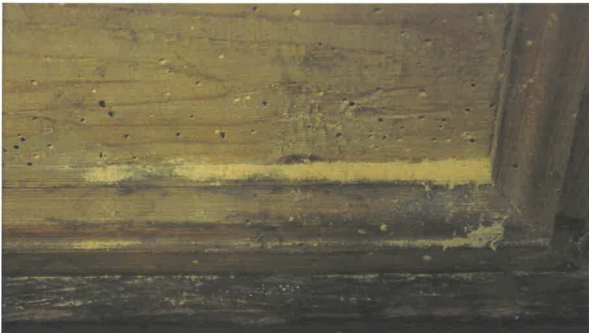
Detailní pohled na výletové otvory dřevokazných škůdců v oblasti vnitřních šuplíků
