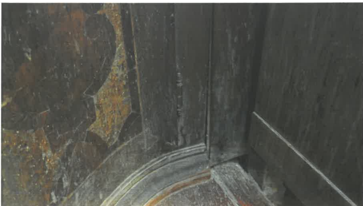
Detail poškození povrchové úpravy povrchovou plísní, důsledek nedostatečné cirkulace vzduchu
