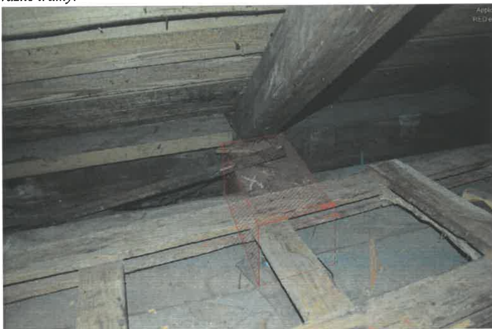
Obr. 7 Vyznačené degradované prvky v detailu spodní části konstrukce – vazný trám.
