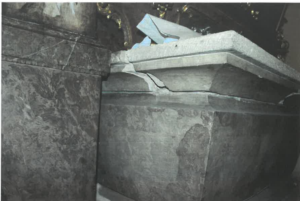
Restaurátorský průzkum - oltář Nanebevzetí P. Marie - nahoře chybějící část mramoru v místě spáry mezi bloky kamene , horizontální trhлина kopíruje spáru bloku
