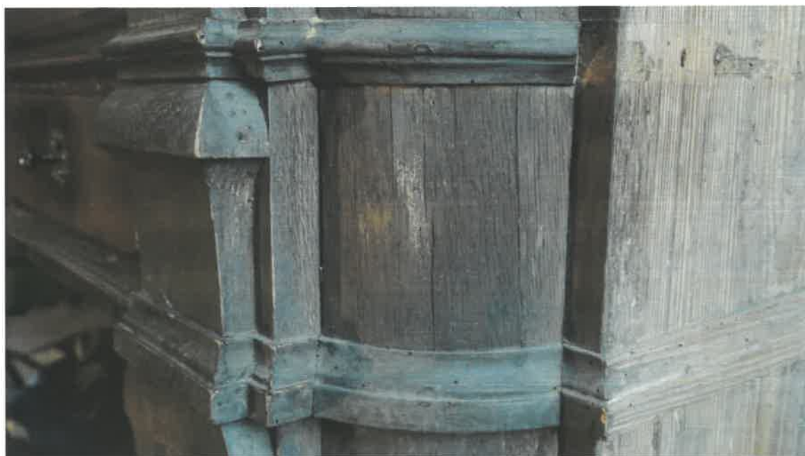
Poškození a degradace dřevní hmoty
