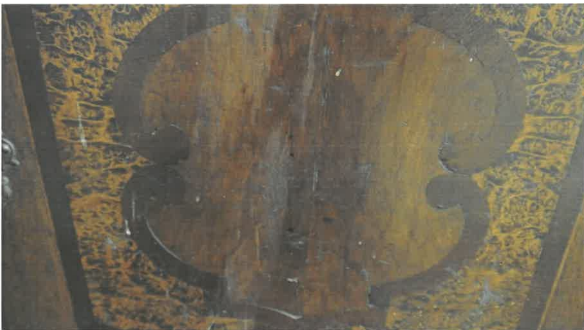
Detail poškození a opotřebení povrchové úpravy
