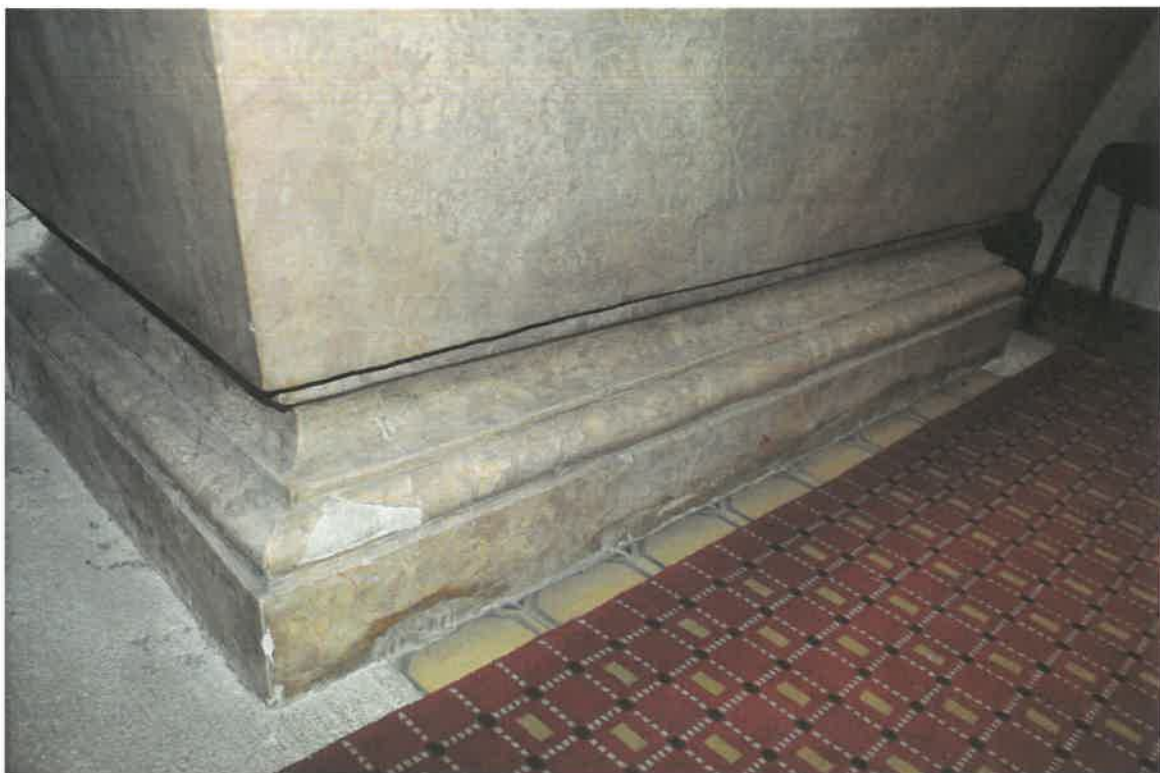
Restaurátorský průzkum - oltář Křtu sv. Augustina - nahoře celkový pohled , dole odpadlý kus vlevo na soklu, spodní okraj soklu je doplňován
