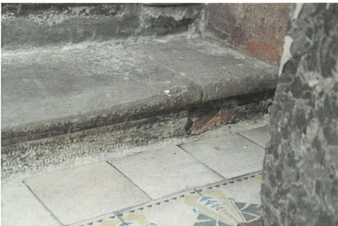
Detail pravé strany schodiště s cementovou opravou. U spodního schodu je viditelná oprava červenou cihlou nebo kamenem.
