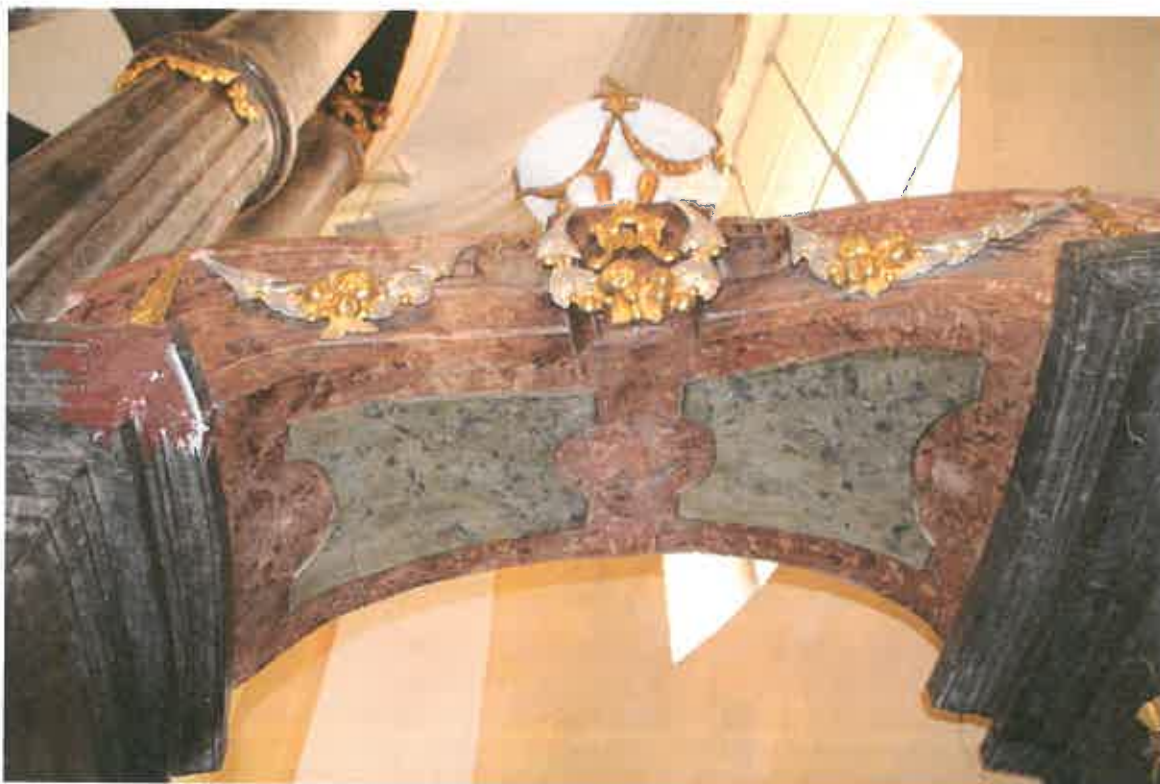
Nahoře detail neodborně provedeního zajištění odpadlého rohu římsy. Dole pohled na pravý oblouk ze spodu.
