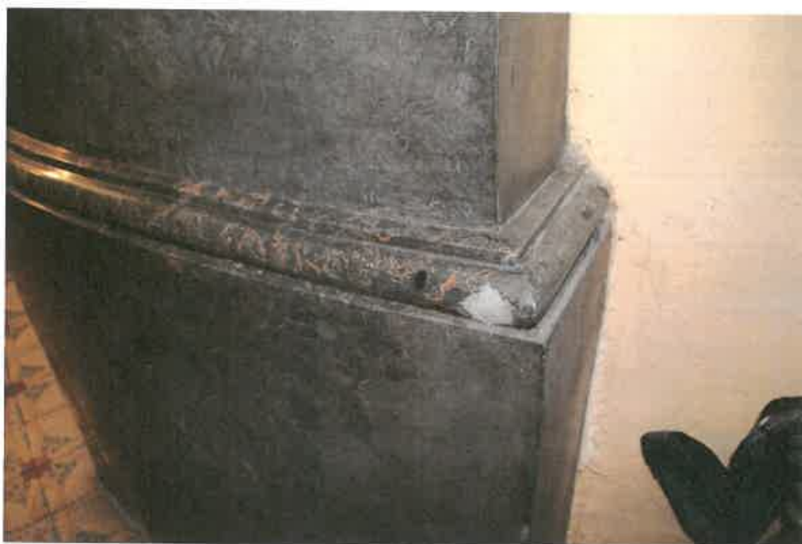
Nahoře detail pravého oblouku ze zadu s prasklinami v maltě. Dole otluk soklu podstavce z levé strany.
