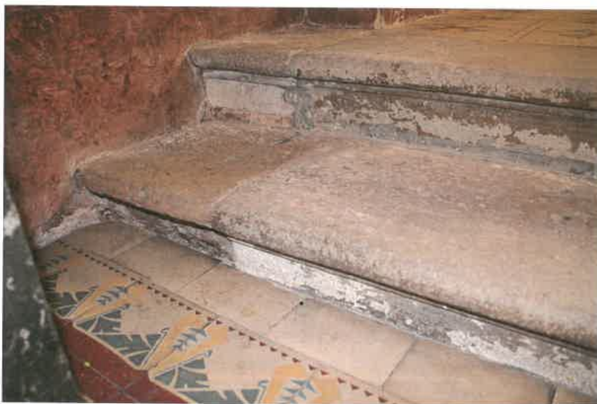
Nahoře pohled z levé strany. Dole detail poškození cementovými tmely, zbytky bílého a hnědého nátěru.
