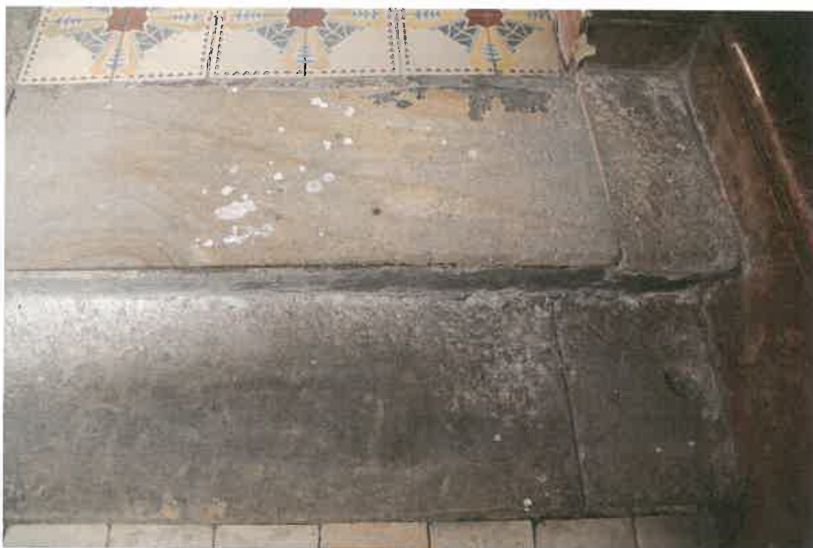
Nahoře dožilé spárování, viditelné zbytky bílého nátěru. Dole pohled shora na poškozené plochy stupňů s cementovými vysprávkami.
