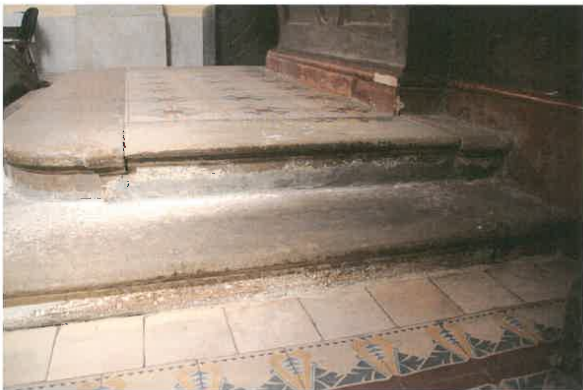
Nahoře pohled na menzu a schodišťové stupně s podestou. dole pohled z pravého boku s viditelnou opravou cementem.
