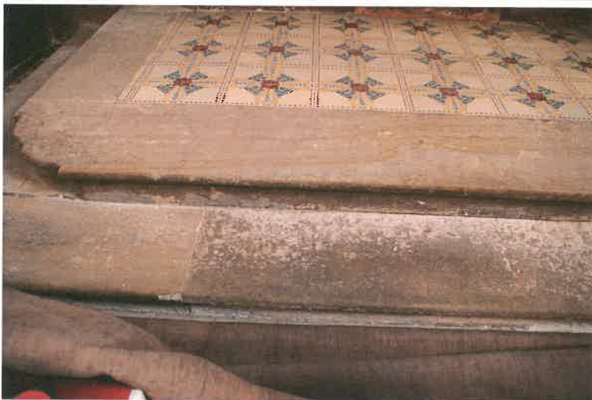
Nahoře větší otlučky a dožilé spárování. Dole erozivní poškození prvního schodu zředu.
