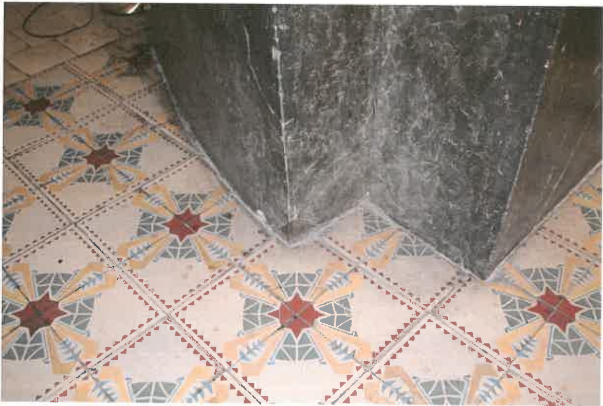
Nahoře detail mramorového vzoru s bílou žílou. Dole silně zašpiněný podstavec v dolní části.
