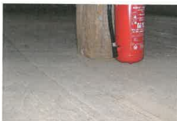
propadená podlahy u sloupu ve 2.NP
