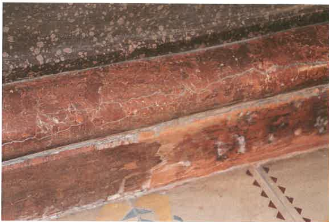
Nahoře detail rozbité soklové části menzy. Dole viditelné rozpraskání oblého profilu v celé délce.
