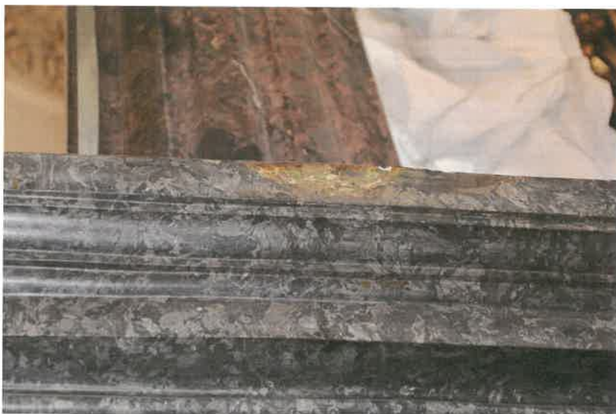
Nahoře mechanicky poškozená plocha podstavce vlevo zrcadlem. Dole neodborně provedená oprava hrany římsy.
