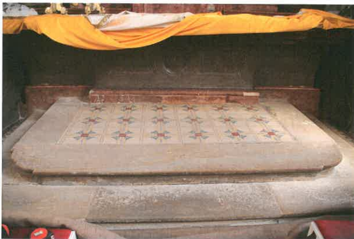
Nahoře detail poškozeného povrchu schodu z předního pohledu. Dole celkový pohled zředu.
