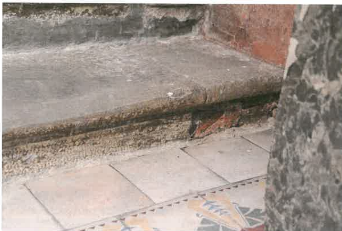
Detail pravé strany schodiště s cementovou opravou. U spodního schodu je viditelná oprava červenou cihlou nebo kamenem.
