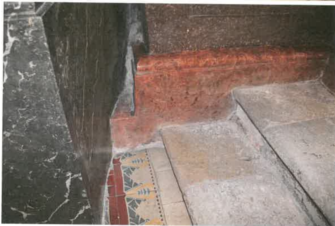
Pohled na oltářní menzu se zabudovanými dvěma schodišťovými stupni. Nahore viditelné poškození soklové části. Dole detail napojení na schody.
