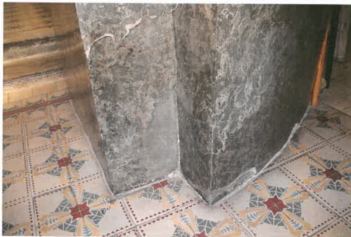
Poškození podstavce v dolní části.
