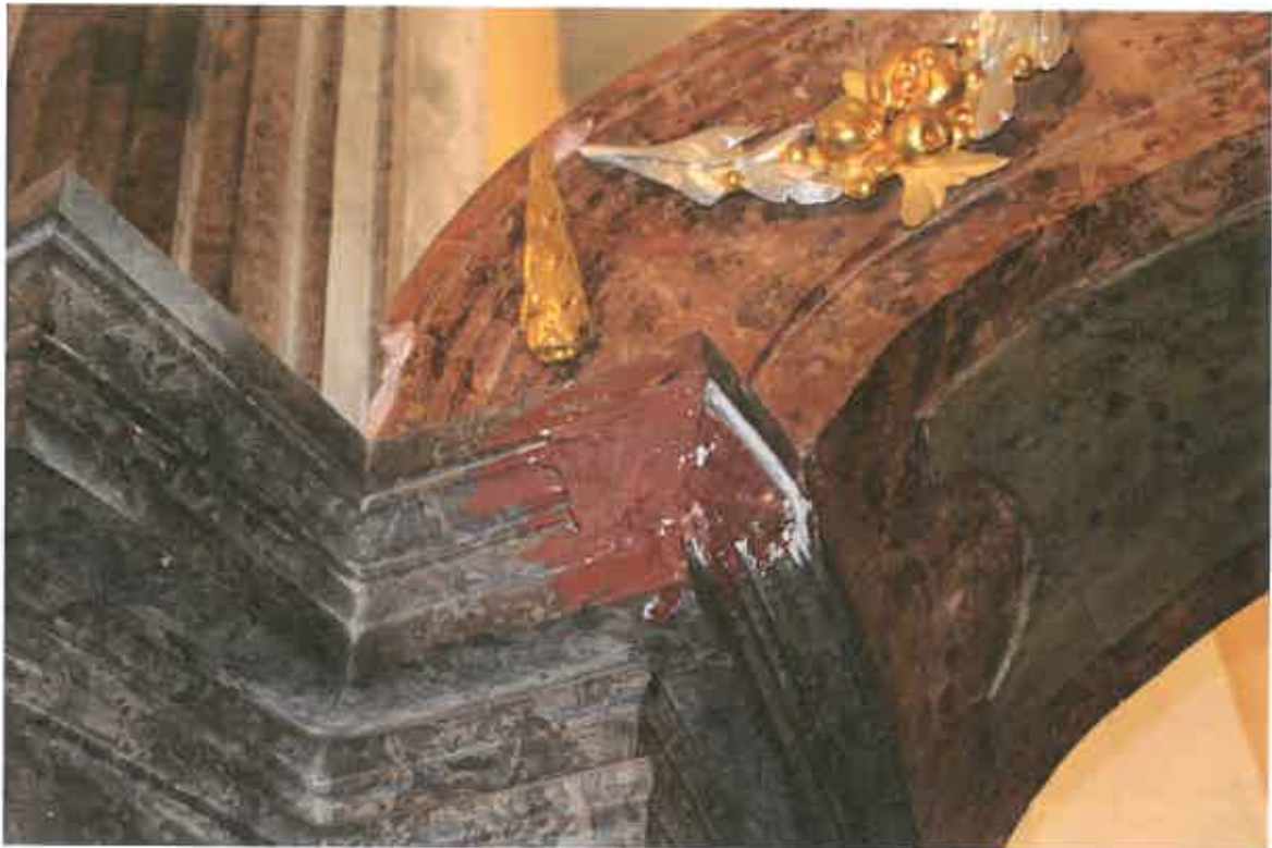
Nahoře detail praskliny v části oblouku. Dole neodborně provedené zajištění odpadlého rohu římsy.
