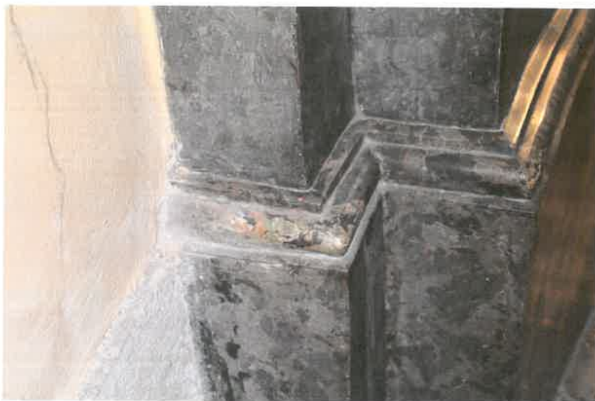
Nahoře detail pravého oblouku s prasklinami. Dole opravený roh umělym mramorem a odlišnou barevností.
