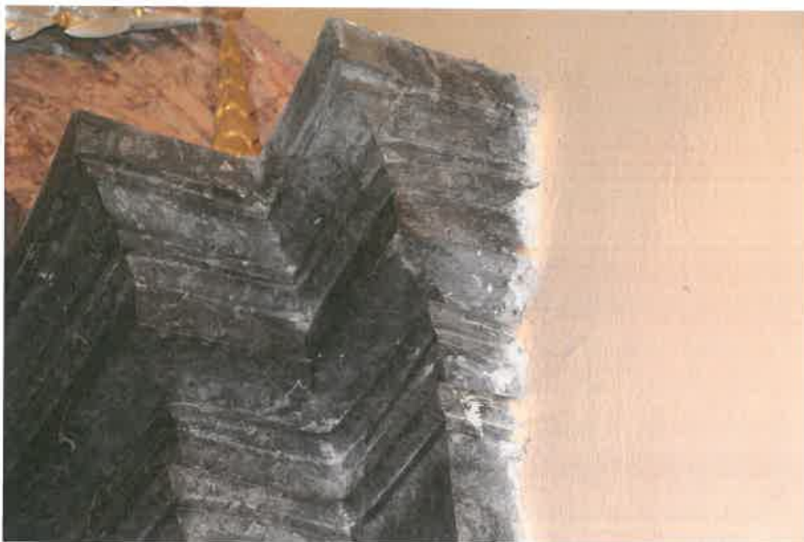
Poškození spodní části podstavce . Dole zaslepená profilovaná římsa nátěrem.
