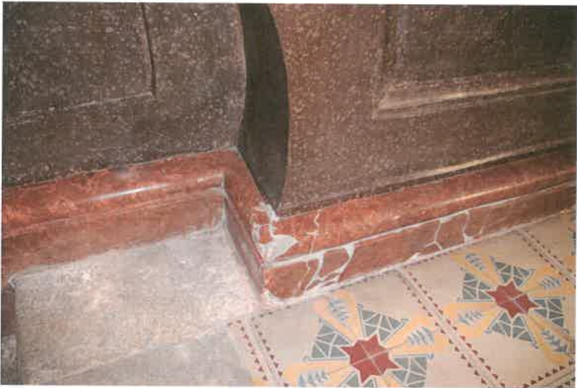
Nahoře levá horní část s doplněným rohem, dole soklová část neodborně opravená.
