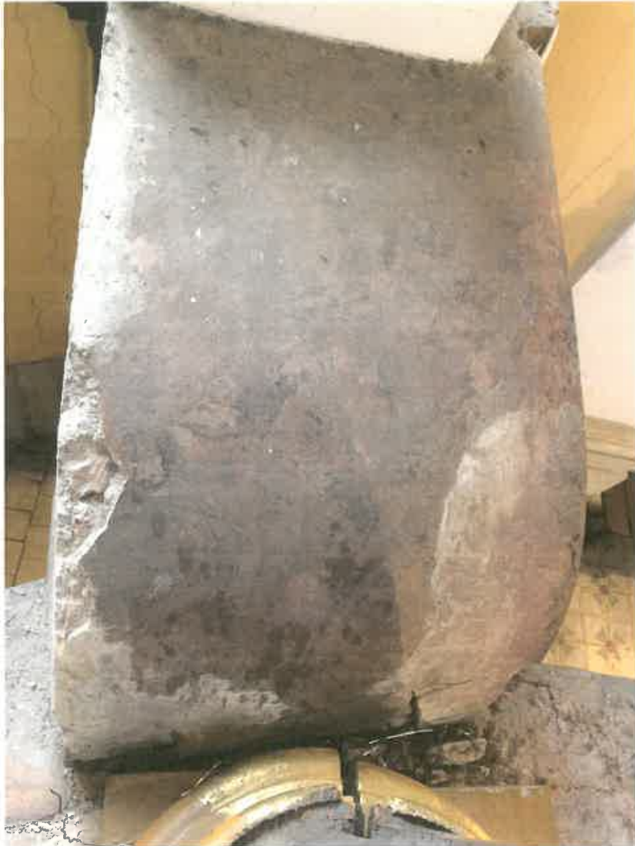
Detail pravého oblouku ze zhora s chybějícím umělým mramorem.
