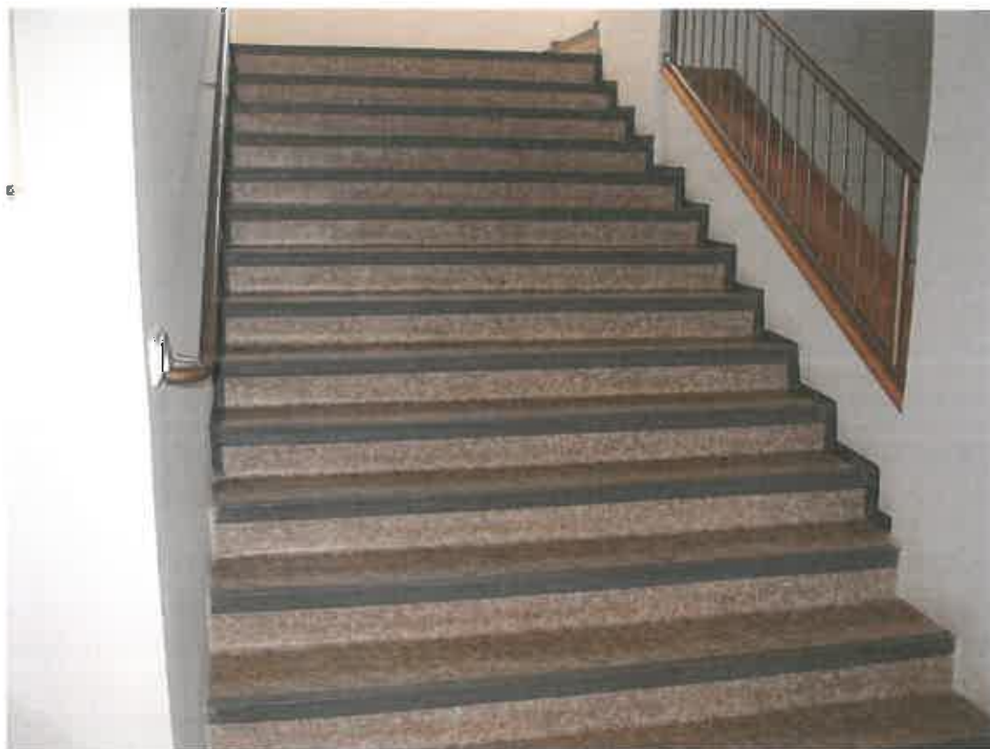
Zámek, ul. U Zámečku (vnitřní schodiště - nevhodné PVC vyměnit za dřevěné schodnice)
