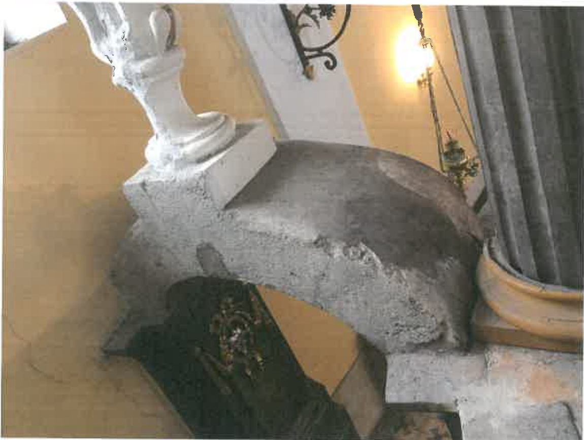
Nahoře pohled na oblouk vlevo s chybějící částí mramorové plochy vyplněné maltou. Dole oblouk vpravo s poškozenou horní částí.
