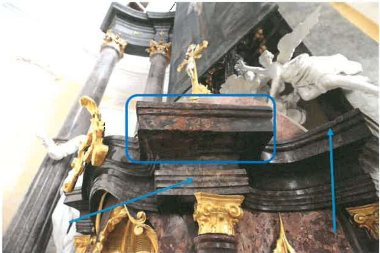
Nekorektné provedená rekonstrukce vysunuté profilace, praskliny v umělém mramoru
