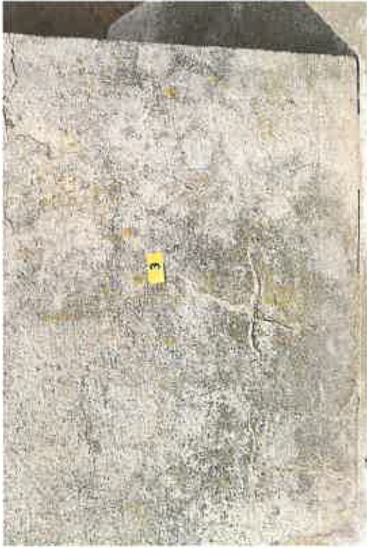
JEVIČKO – KAMENNÝ KRÍŽ – Praskliny na soklové části, vyplněné suti
