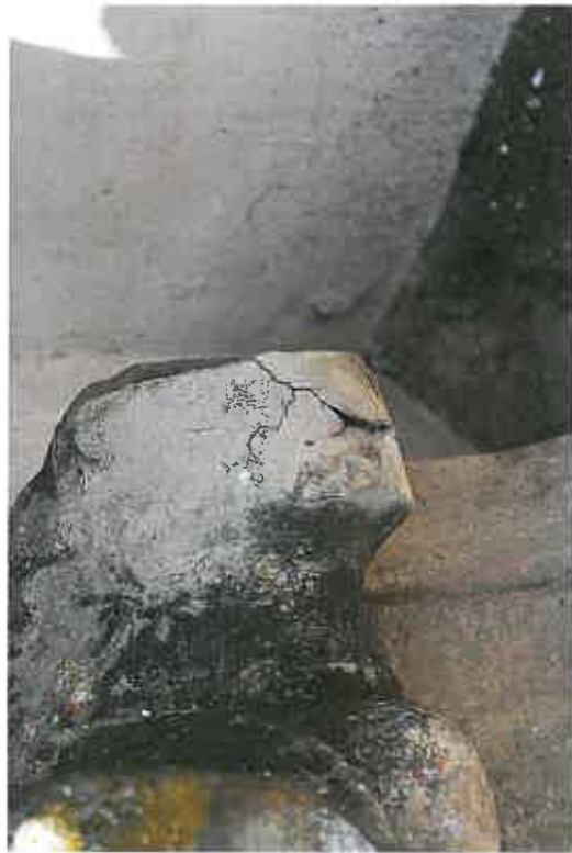
JEVIČKO – PORTÁL, LEVÝ ANDĚL, UKONČENÍ VOLUTY PODSTAVCE, PRASKLINA VE ŠTUKOVÉ HMOTĚ
