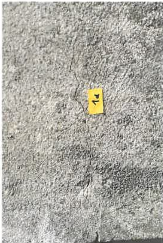
JEVIČKO – KAMENNÝ KŘÍŽ – Praskliny na soklové části, řasy a lišejníky
