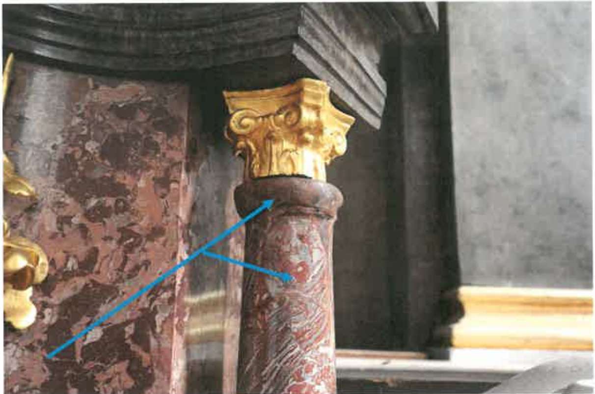
Starší neodborné zásahy a praskliny na hlavici a dříku pravého sloupku
