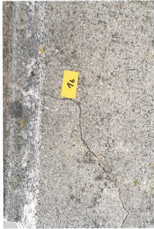
JEVIČKO – KAMENNÝ KŘÍŽ – Praskliny na soklové části
