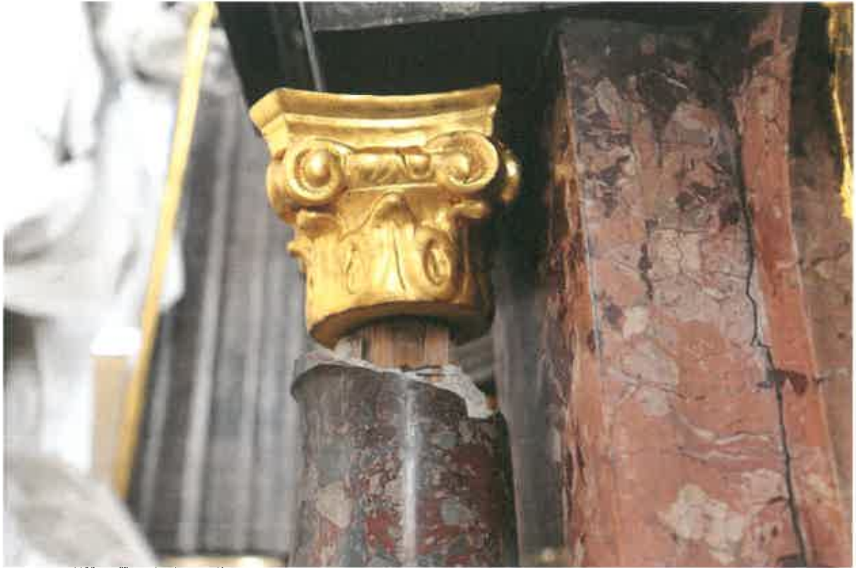
Detail hlubších prasklin, konstrukce a poškození sloupku
