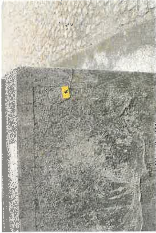
JEVIČKO – KAMENNÝ KŘÍŽ – Praskliny na soklové části
