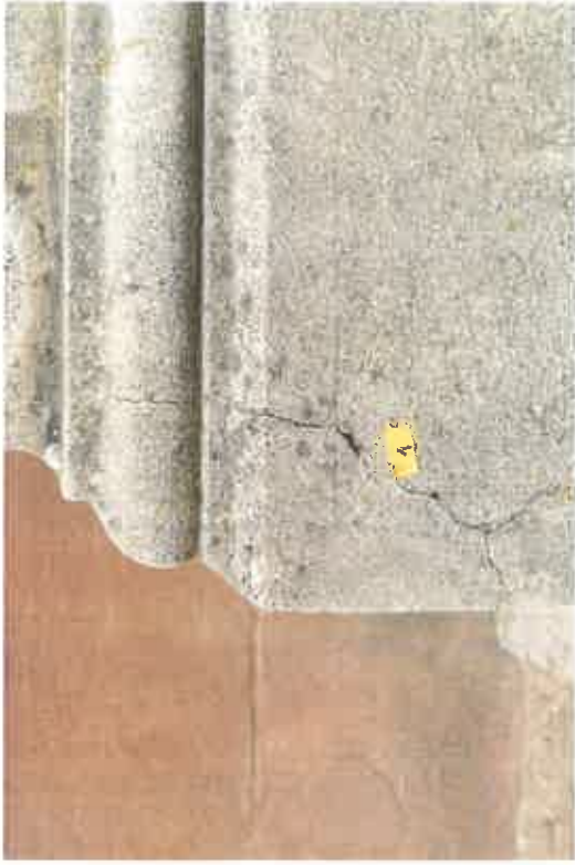
JEVIČKO – KAMENNÝ KŘÍŽ – Praskliny na soklové části
