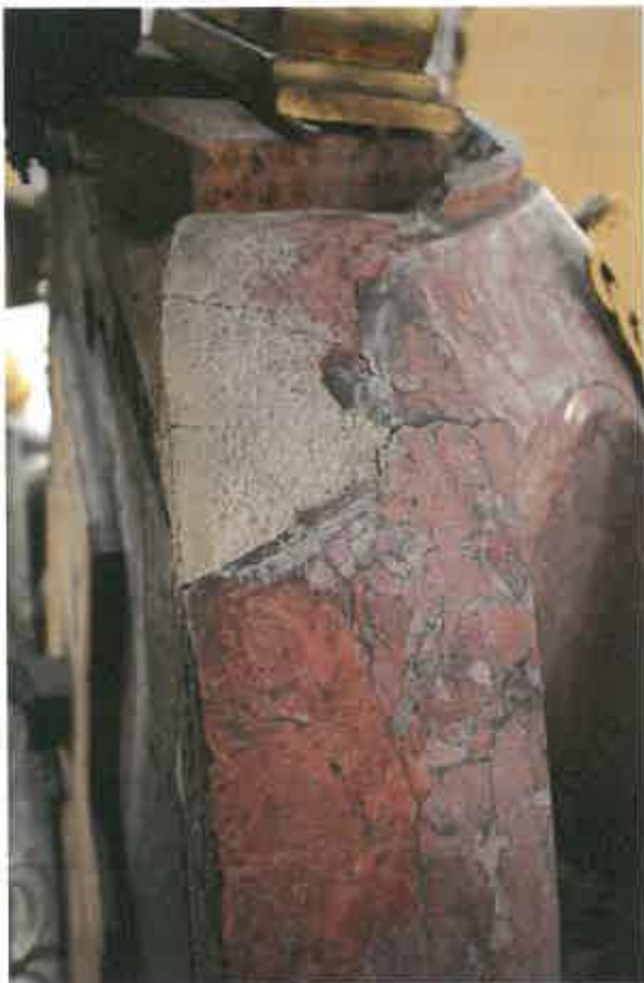
Značně poškozené horní a boční partie kopule
