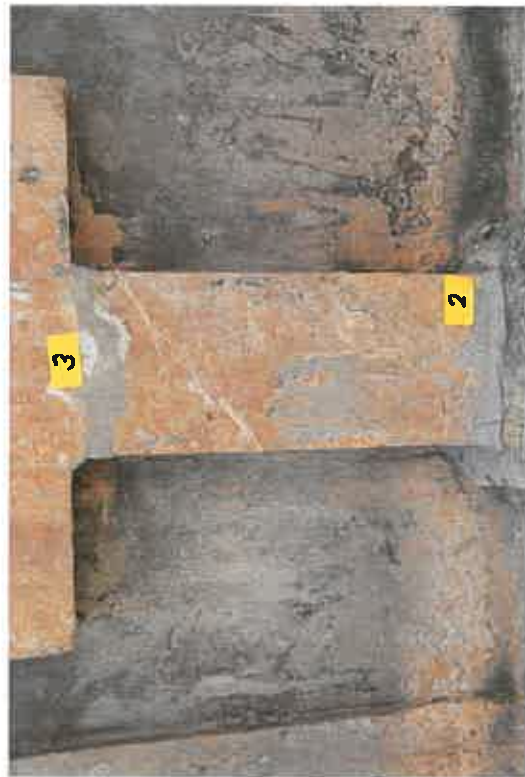
JEVIČKO – ROKOKOVÝ KŘÍŽ – spodní díl podstavce, cementové výplně spár po prasklinách
