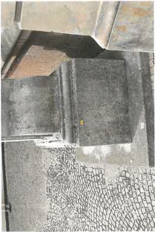
JEVIČKO – KAMENNÝ KŘÍŽ – Praskliny na soklové části
