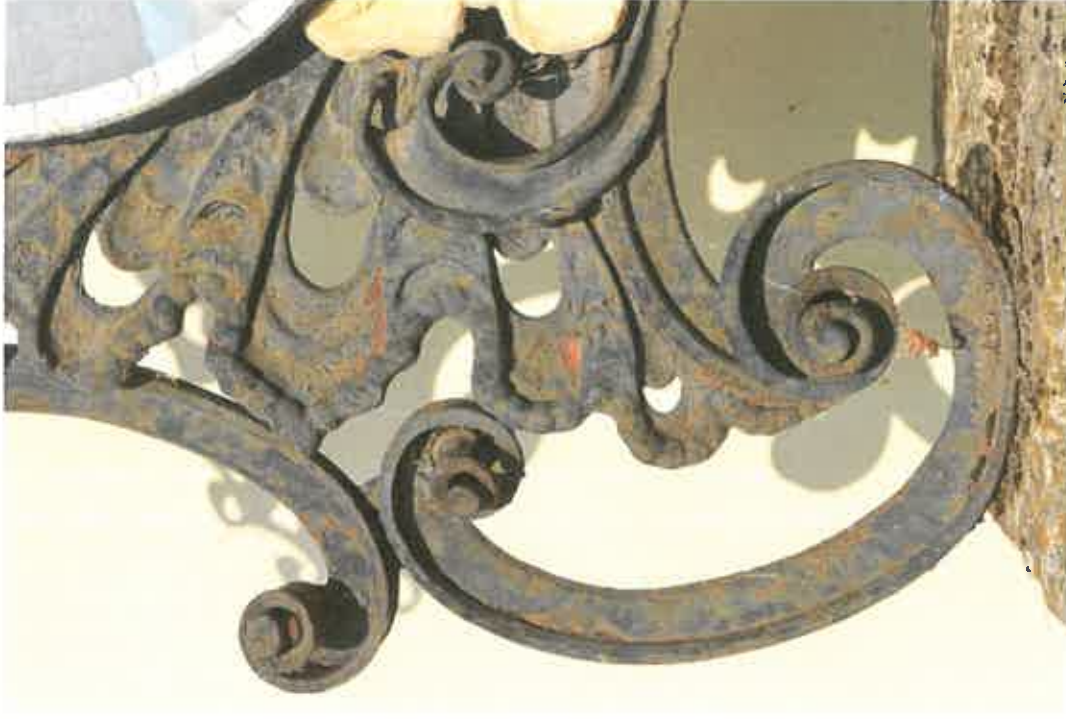
JEVÍČKO – ROKOKOVÝ KŘÍŽ – detailní pohled na stav kovové části
