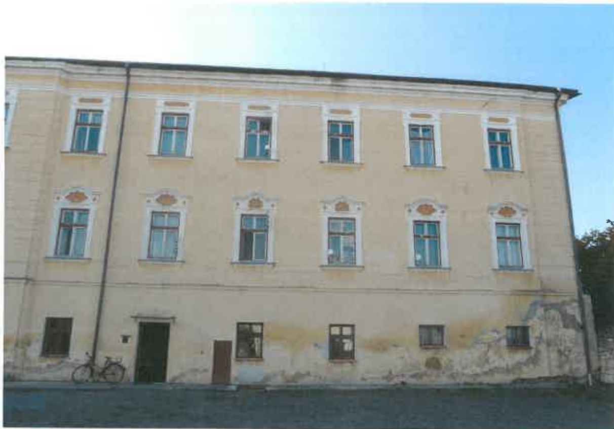
Prelatura bývalého augustiniánského kláštera před a po obnově soklové části omítky (vč. výměny otvorových prvků, 2012 – 2013):
