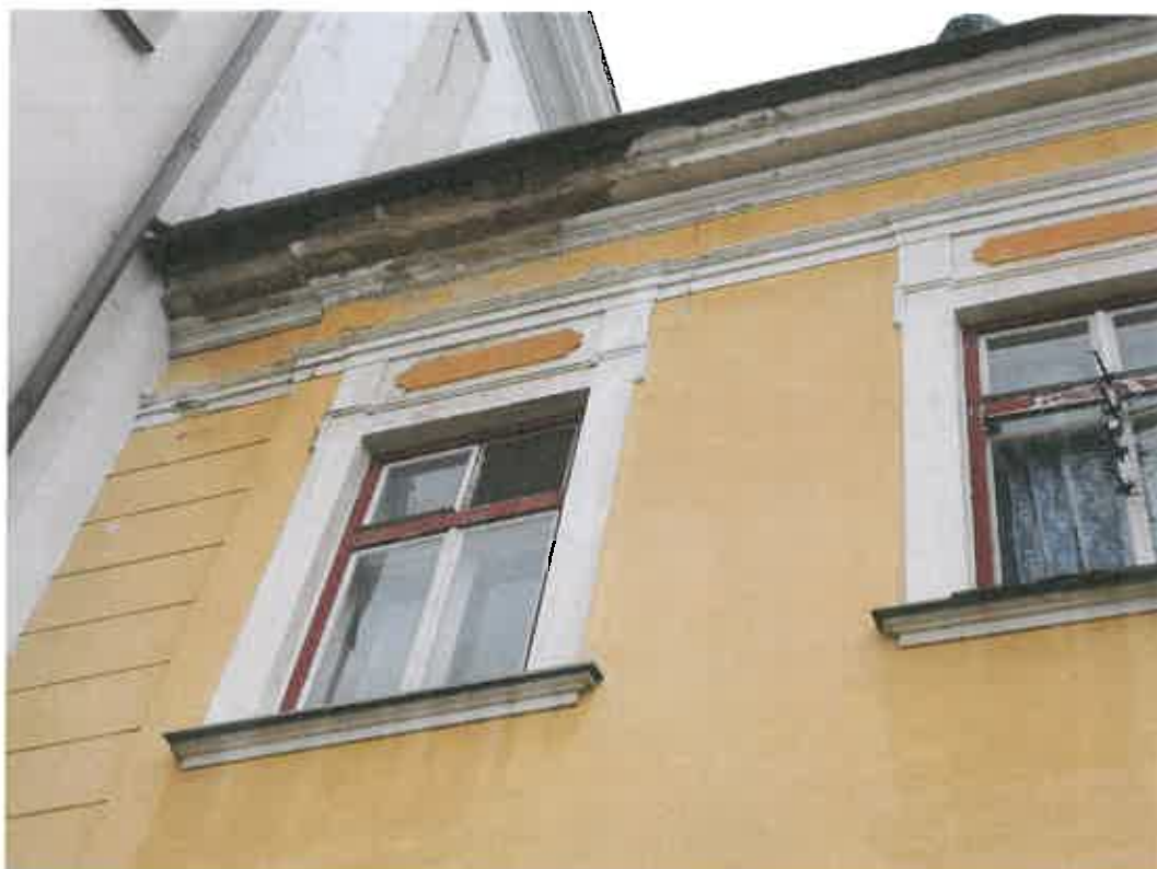
Bývalý augustiniánský klášter, ul. Soudní čp. 51 (severní křídlo) (detail zamoklé římsy)
