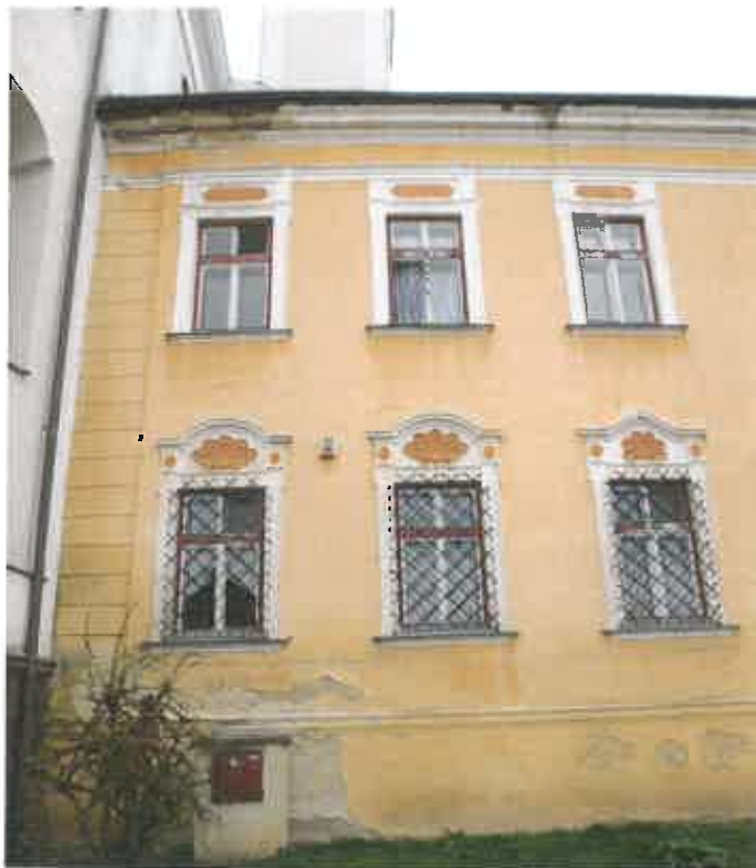
Bývalý augustiniánský klášter, ul. Soudní čp. 51 (severní křídlo) (obnova fasády, klempířské prvky - provést revizi, případně výměnu)
