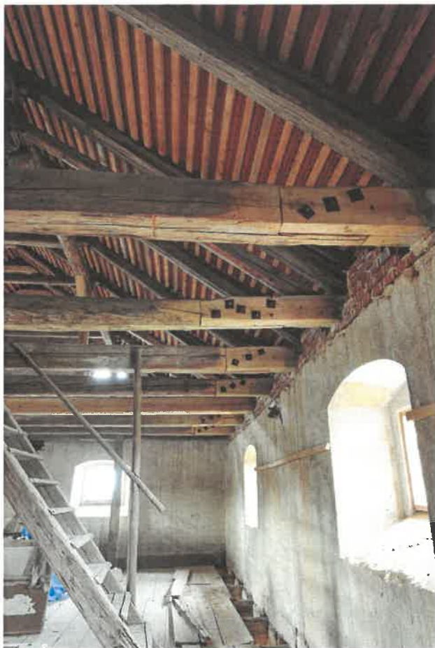
23. Protézování vazných trámů s plátovými svorníkovými spoji, provedené v rámci opravy krovu a střechy po roce 2010
