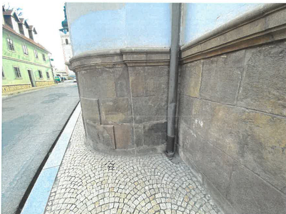
Dole 2. dešťový svod s čistící šachtou.
