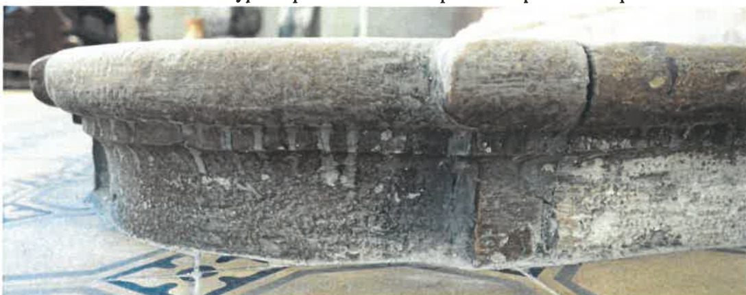
Obr.4. Typická poškození: detail nástupnice schodu, druhotné dožilé hnědé nátěry, spárování provedené nevhodnou tvrdou šedou cementovou maltou a znečištění usazenými depozity.
