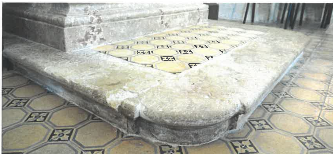
Obr.3. Typická poškození: lokální poškození profilace stupňů.
