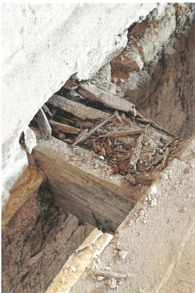
12. Zhlaví stropního trámu nad 1. NP při západní obv. zdi, silně poškozené dřevomorkou a červotočem
