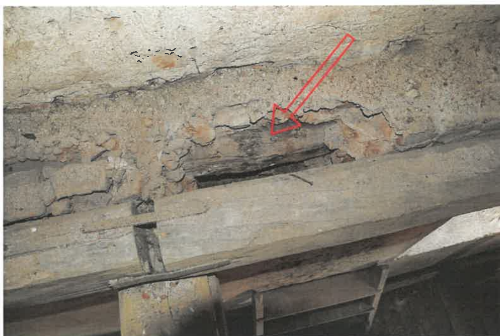
30. Nález dubového trámku , plně zazděného za krajním stropním trámem do jižní obvodové zdi. Patrně se jedná o dřevěnou zední kleštinu
