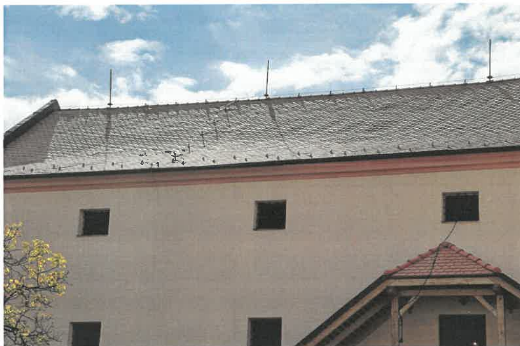
4. Deformace střešní roviny a stav krytiny z keramických tašek bobrovek.
