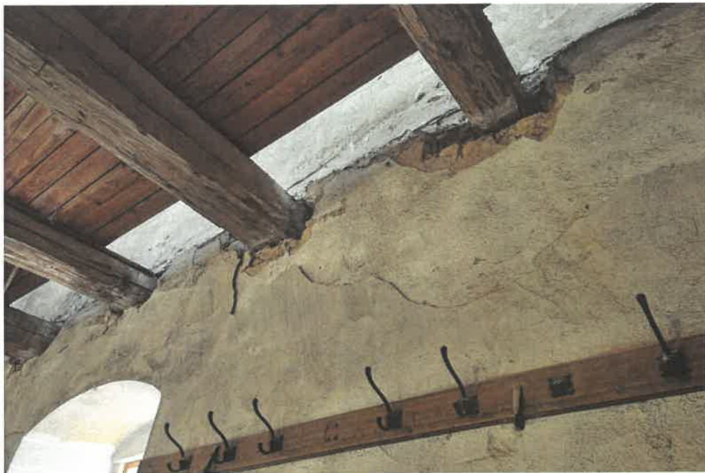
15. Zhlaví stropních trámů nad 2. NP, vysekaná ze zaldění v rámci průzkumu. Pod nimi patrné vrstvení omítek z různých stavebních oprav interiéru.
