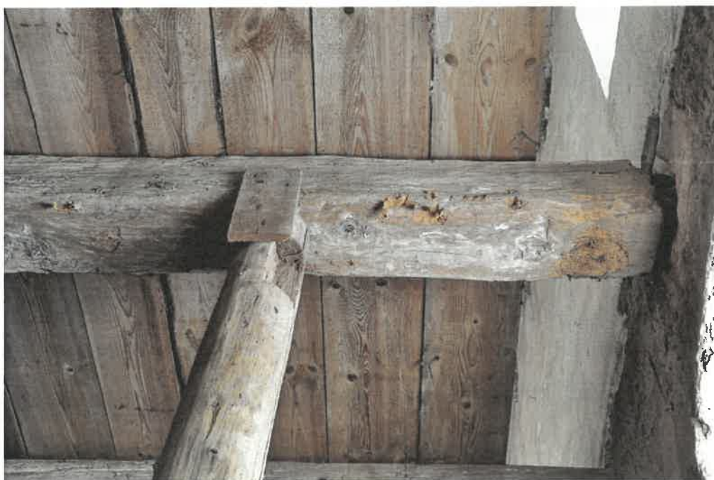
8. Konec stropního trámu nad 1. NP u západní obvodové zdi, silně napadený dřevomorkou (ve zdi) a červotočem.
