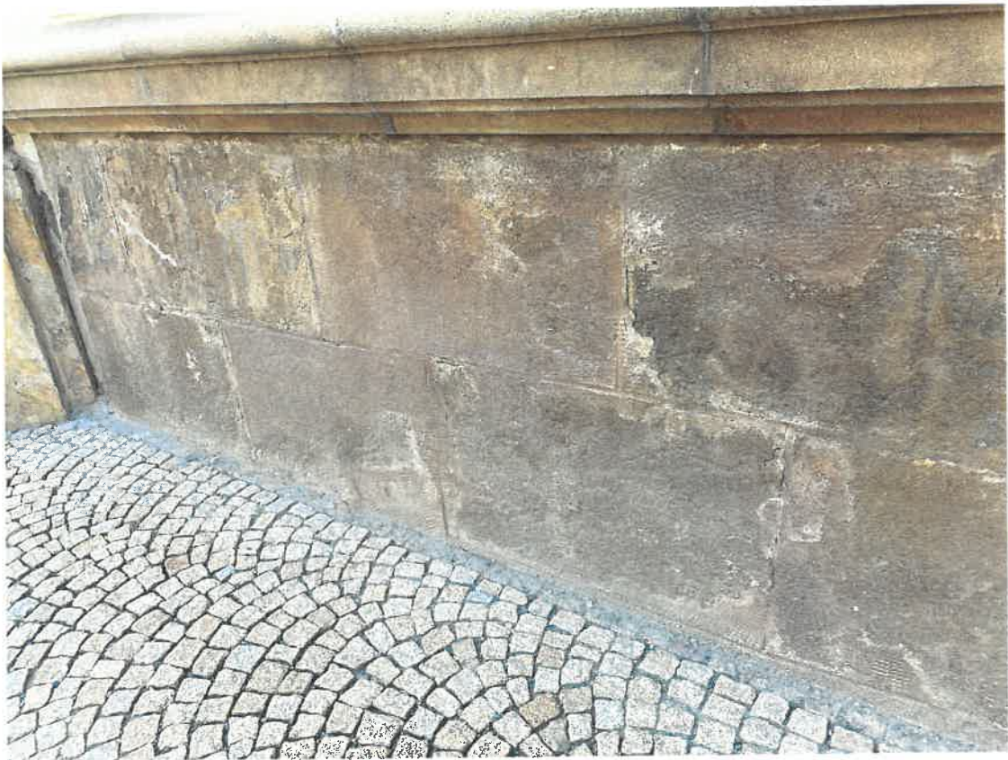
Nahoře čelní pohled na jižní část vpravo od portálu. Viditelné různě barevné mapy tvarových doplňků, které mají světlé ohraničení, některé doplňky jsou odtržené od kamene.
