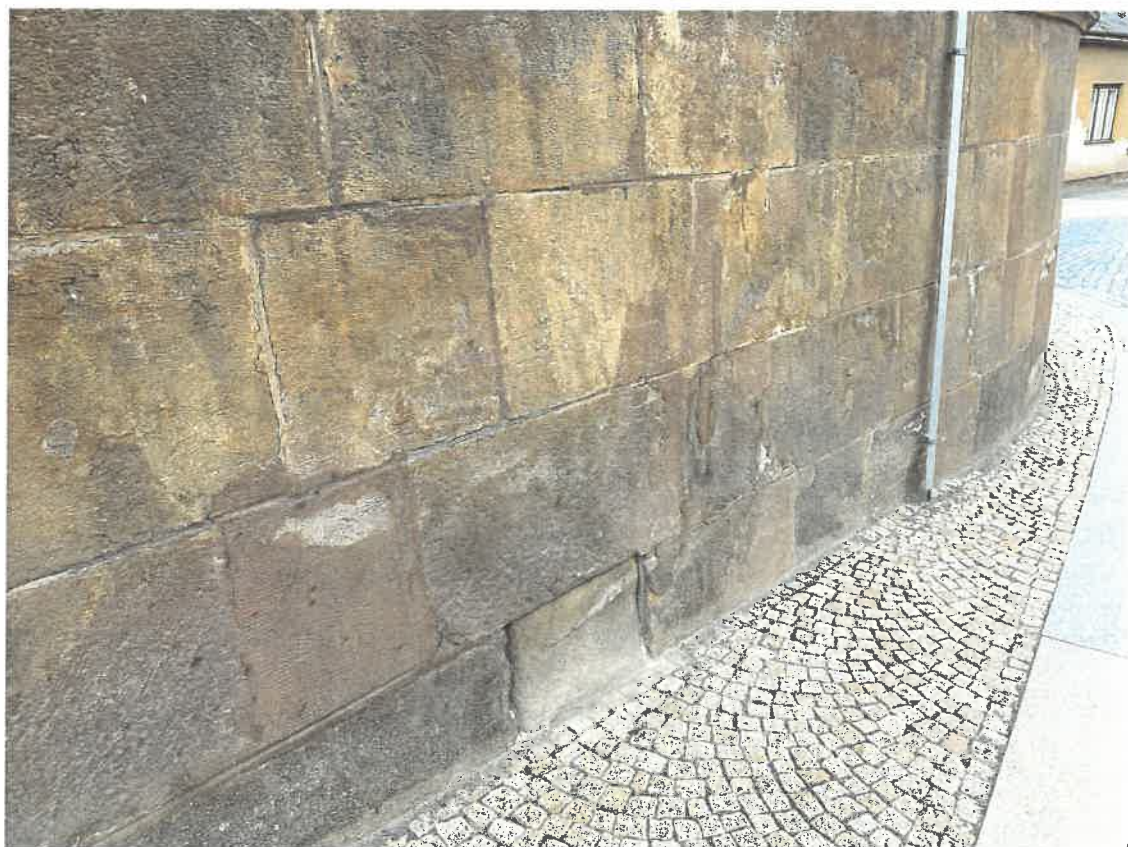
Nahoře celkový pohled na část sakristie. Dole viditelné poškození spodního kamene.
