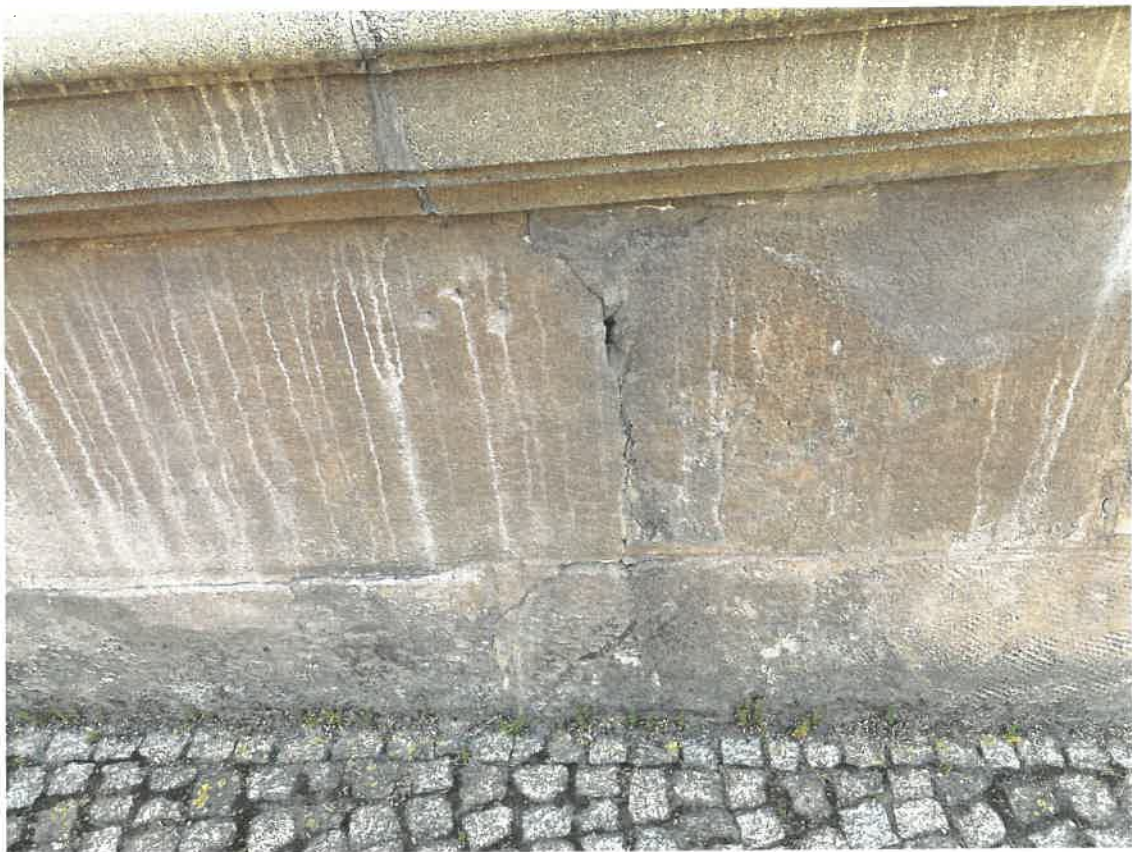
Chybějící spárovánína římse, trhlina ve spáře způsobená zatékající vodou
