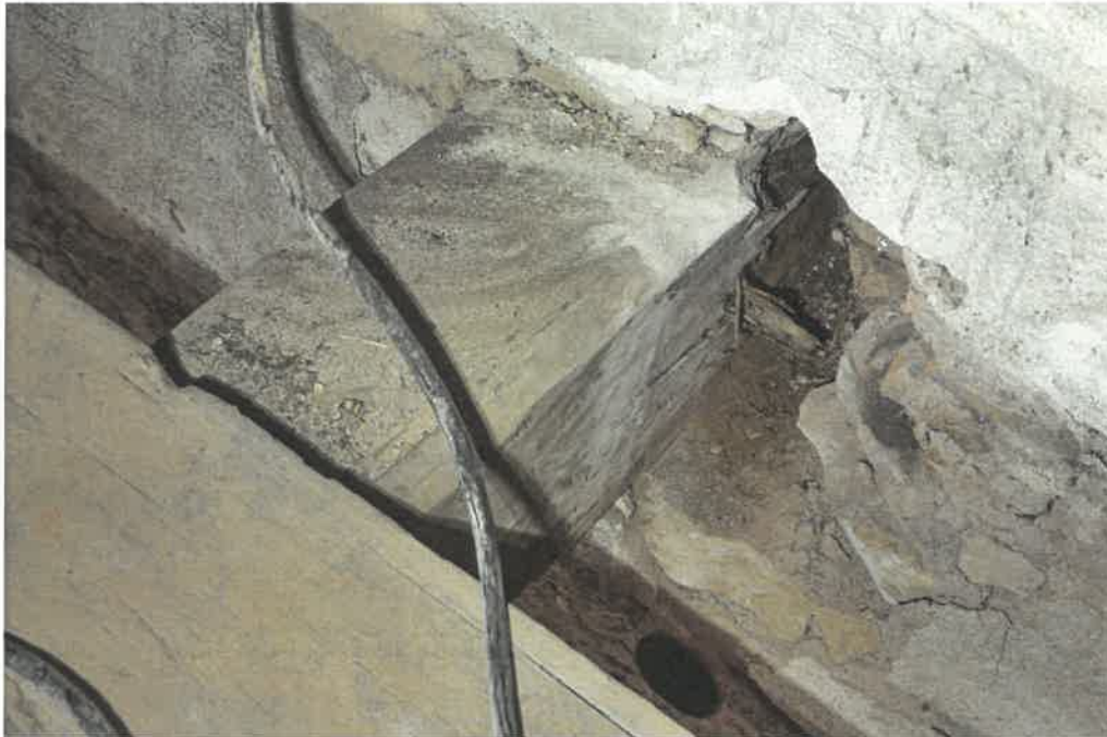
17. Zhlaví stropního trámu nad 2. NP při východní obv. zdi, poškozené dřevomorkou a červotočem
