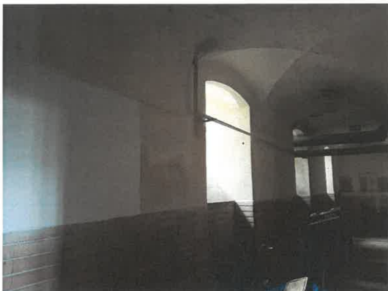
Nahoře: jižní polovina chodby, patrné zavlhčení do výše 1,8 až 2,0 m nad podlahou
