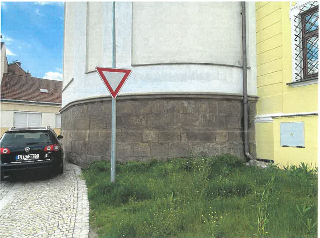
Nahoře detail 3. svodu s viditelnou poruchou odvodu srážek. Zde již trhlina v korunní římsce a do hloubky opadaná profilace římsy kolem svodu. Dole zaústění do systému dešťové kanalizace a pohled na zadní část podezdívky.
