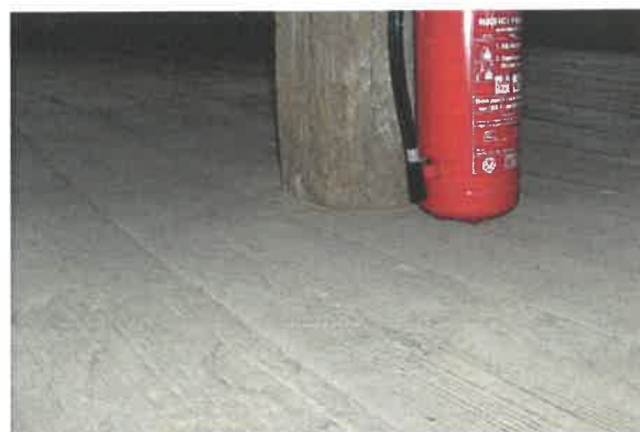
propadená podlahy u sloupu ve 2.NP
