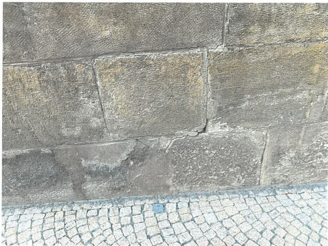
Trhliny způsobené zatékáním vody.
