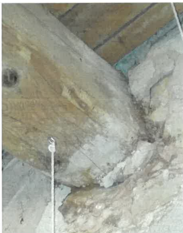
napadené zhlaví stropnic 1.NP
