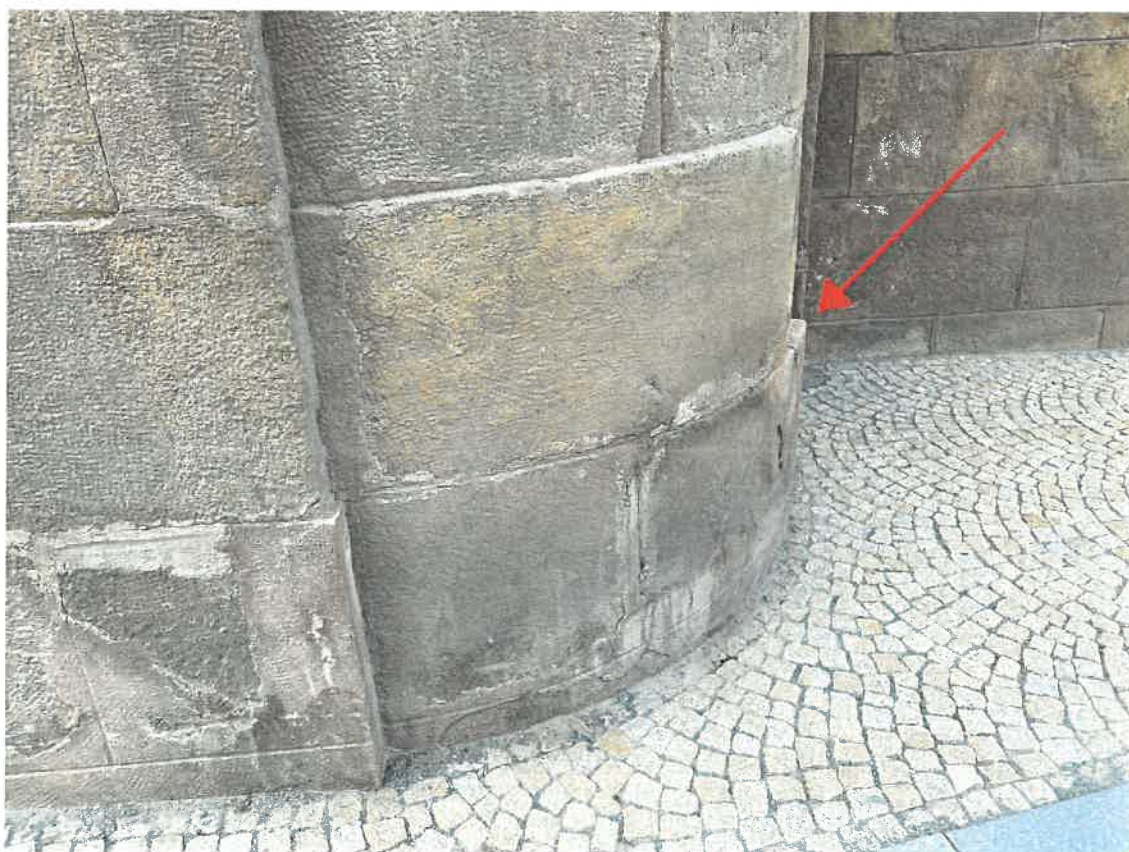
Nahoře viditelné tvarové doplňky s trhlinami. Dole jsou vidět vysunuté konkávní kamenné desky .
