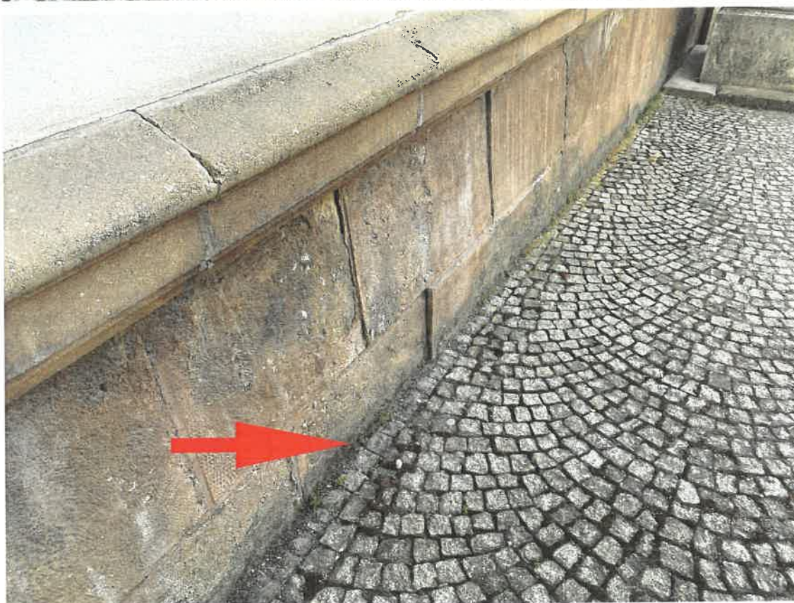
Trhliny ve spárování , různě vysunuté kamenné desky způsobilo dlouhodobé zatékání. Chybějící spárování na průběžné římsě. Někde v těchto místech se má nacházet okno do krypty.
