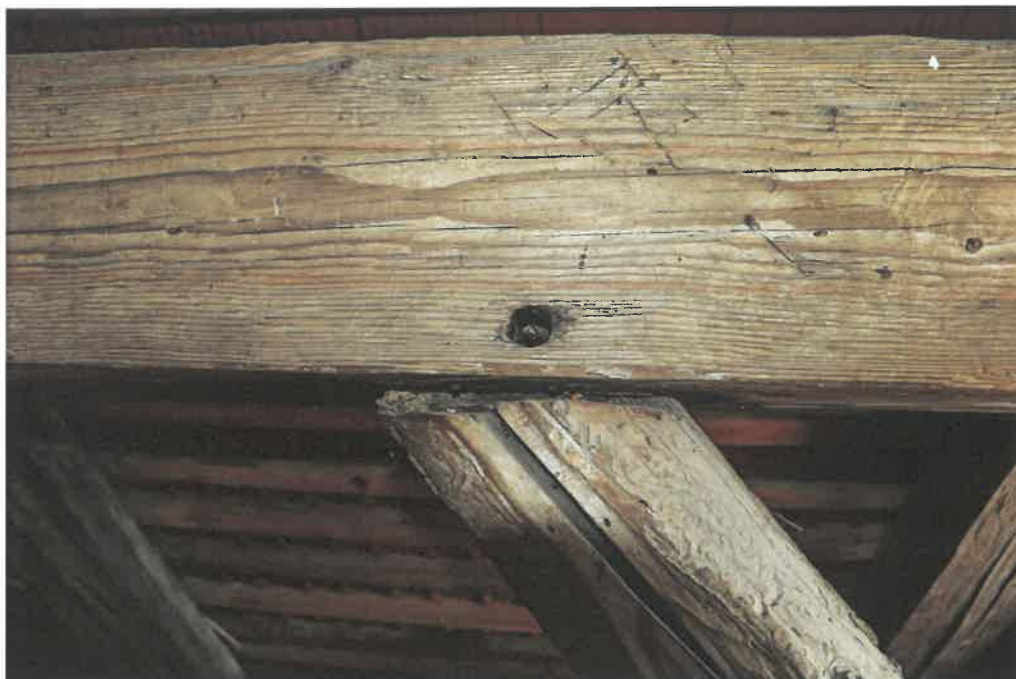
31. Chybějící zajišťovací kolký čepů pásků v plných vazbách krovu. Čep je částečně uvolněný
