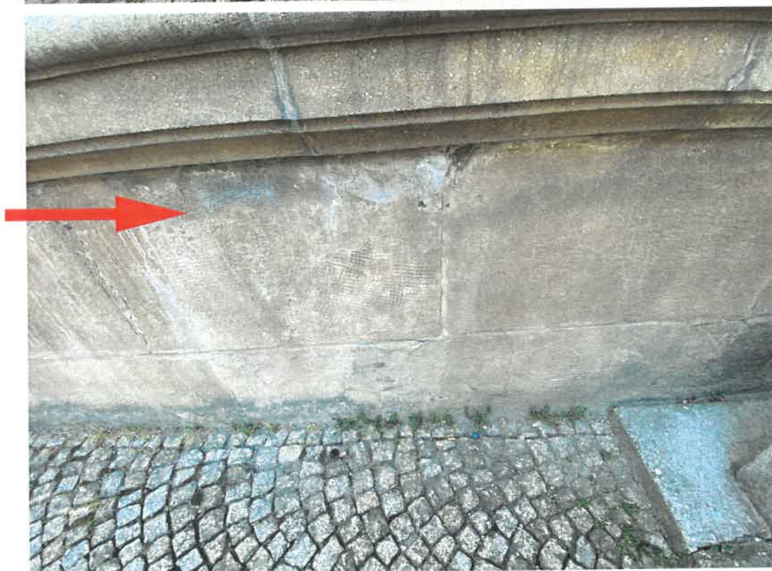
Pohled na levou stranu kamenné podezdívky s hmotnou průběžnou římsou z umělého kamene. Nahoře vysunuté kamenné desky. Růst vegetace podél chodníku svědčí o zamokření v době dešťových srážek. Výkvěty solí na povrchu kamene.
