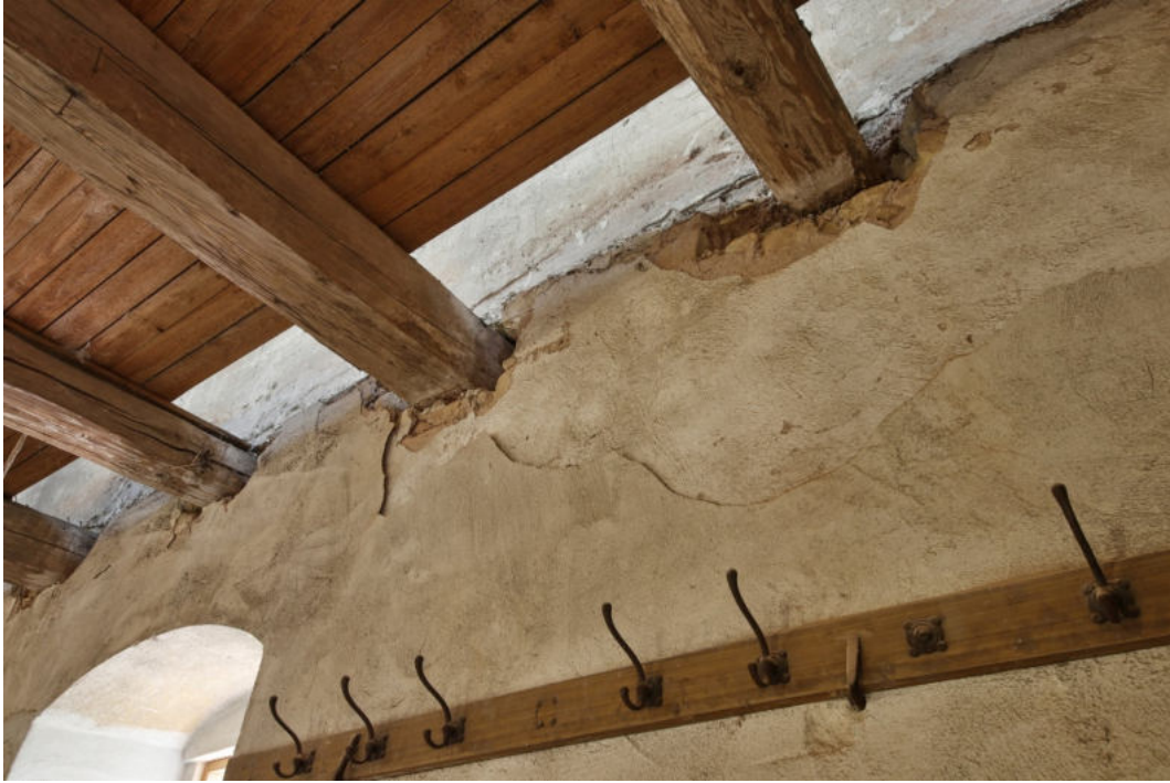
15. Zhlaví stropních trámů nad 2. NP, vysekaná ze zadržení v rámci průzkumu. Pod nimi patrné vrstvení omítek z různých stavebních oprav interiéru.
