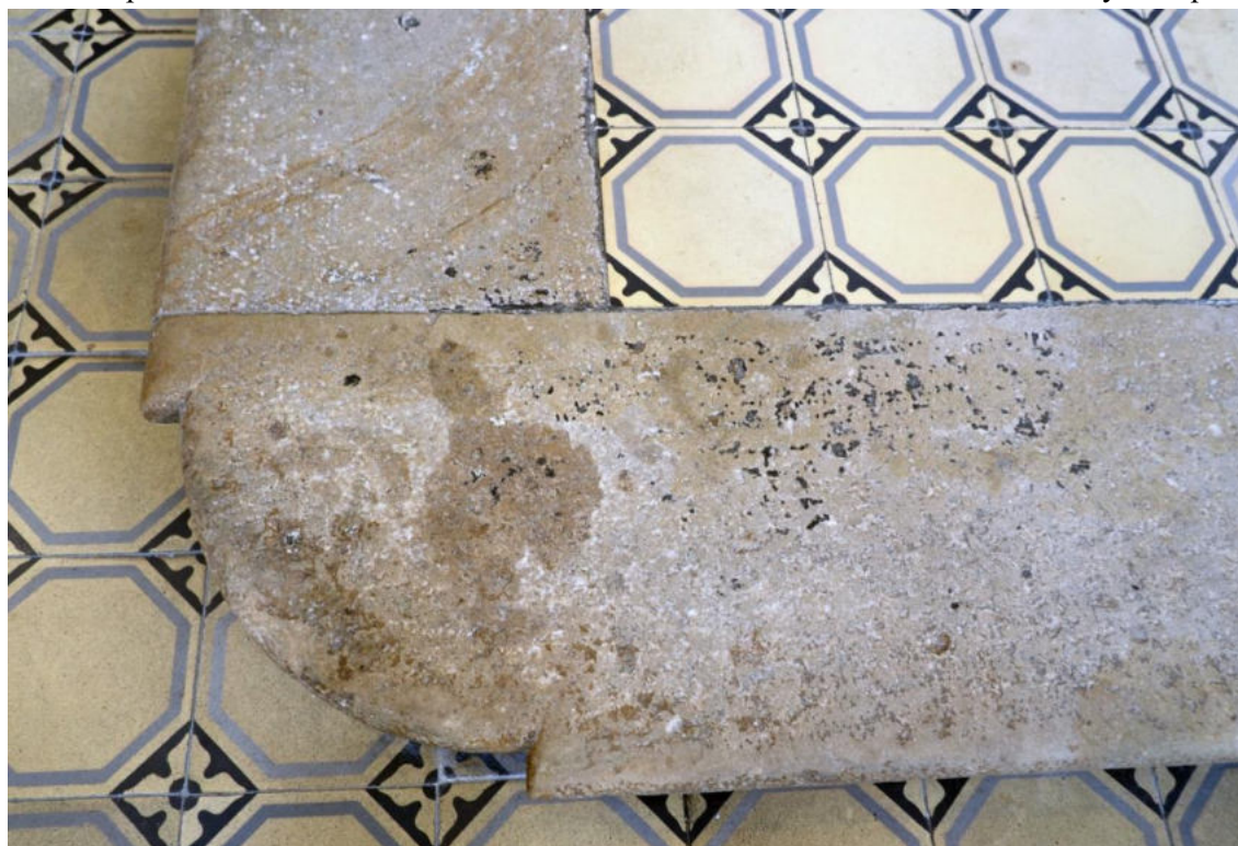
Obr.5. Typická poškození: znečištění povrchu mastnými skvrnami (asi od svíček) a černými zbytky patrně druhotných povrchových úprav (tmelů).
