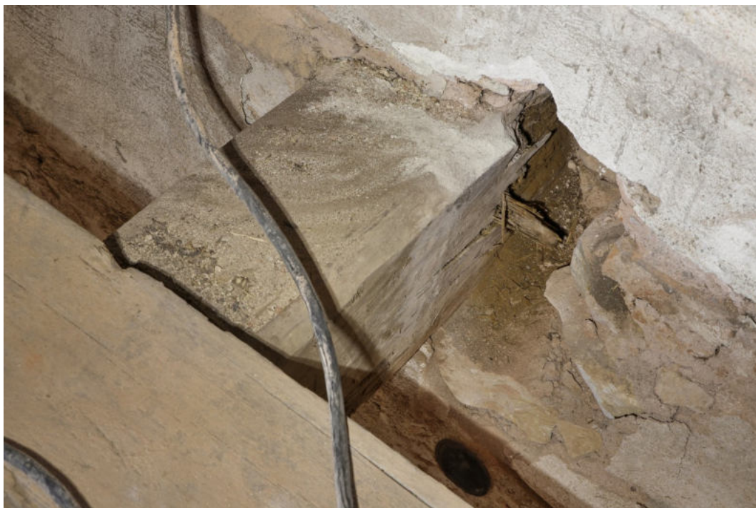
17. Zhlaví stropního trámu nad 2. NP při východní obv. zdi, poškozené dřevomorkou a červotočem
