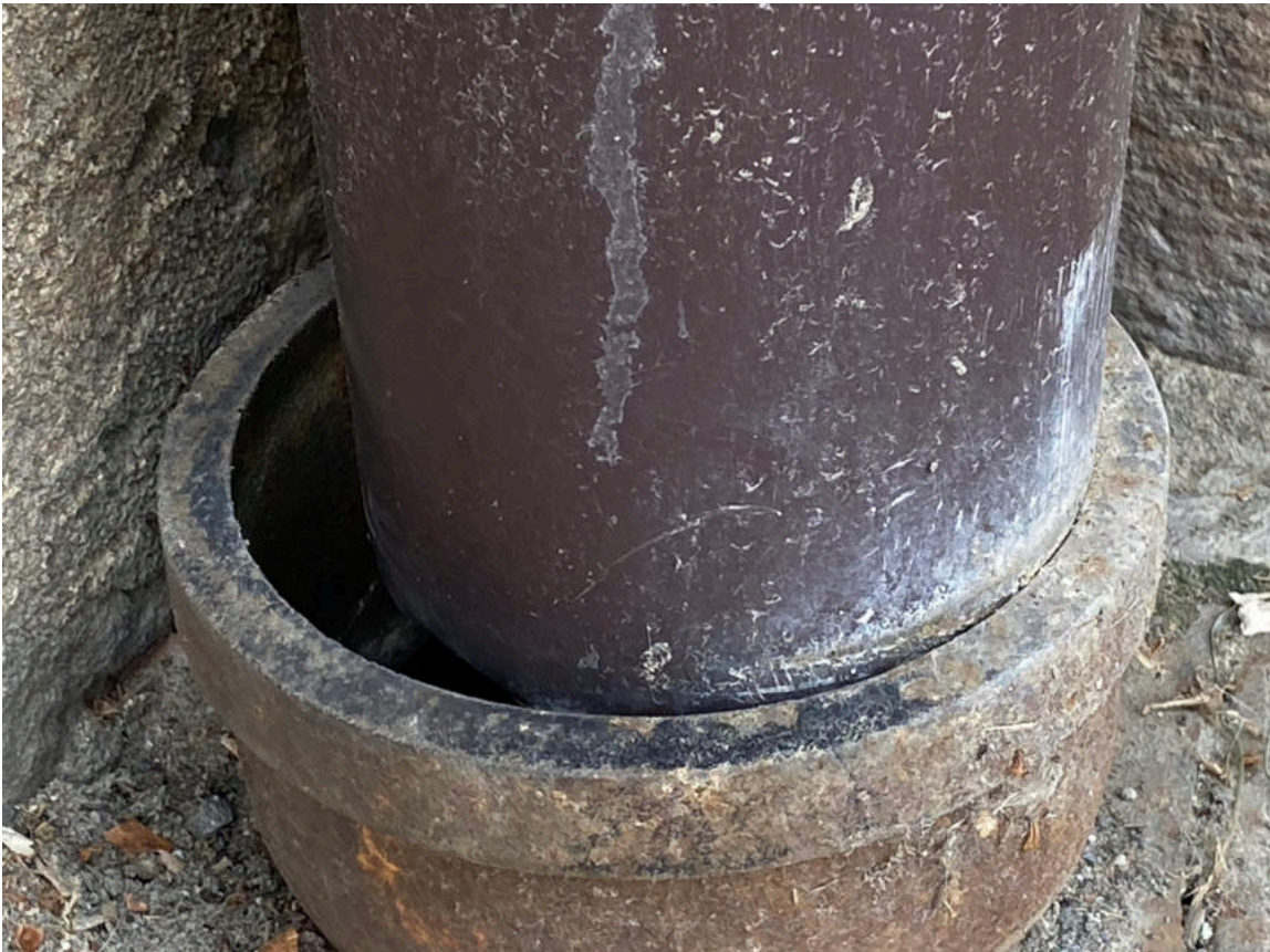
Detail zaústění svodu do silnostěnné trubky, svod je zapuštěn cca 1 cm . Při dešťových srážkách musí voda přetékat přes okraj trubky.
