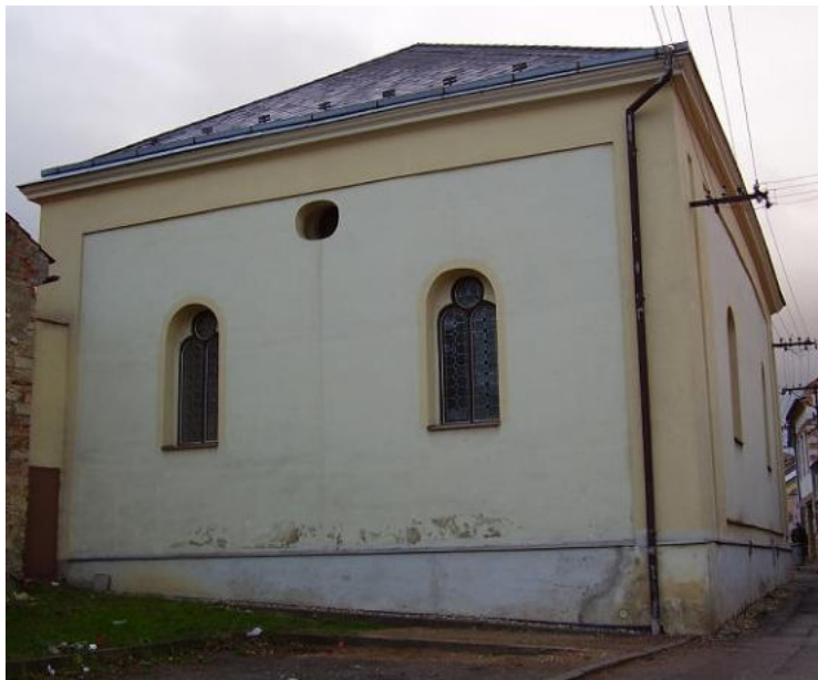
Fotografie před a po obnově fasády na východní a severní straně synagogy v r. 2013:
