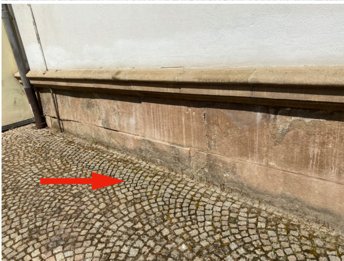
Pohled na levou stranu kamenné podezdívky s hmotnou průběžnou římsou z umělého kamene. V rohu sousedí s Muzeem je 1. svod zapuštěný do chodníku. Tmavé mapy podél chodníku svědčí o zamokření v době deštových srážek. Voda stékající z korunní římsy vymývá štěrky ze spár dlažebních kostek.
