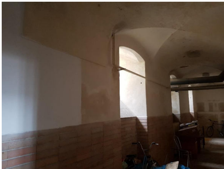
Nahoře: jižní polovina chodby, patrné zavlhčení do výše 1,8 až 2,0 m nad podlahou
