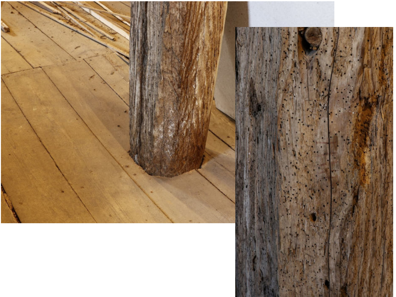
16. Jižní sloup ve 2. NP silně poškozený červotočem. Vpravo detail povrchu sloupu s výletovými otvory
