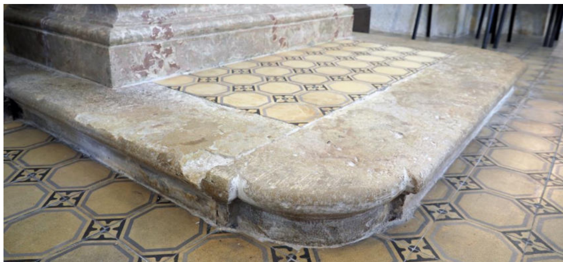
Obr.3. Typická poškození: lokální poškození profilace stupňů.
