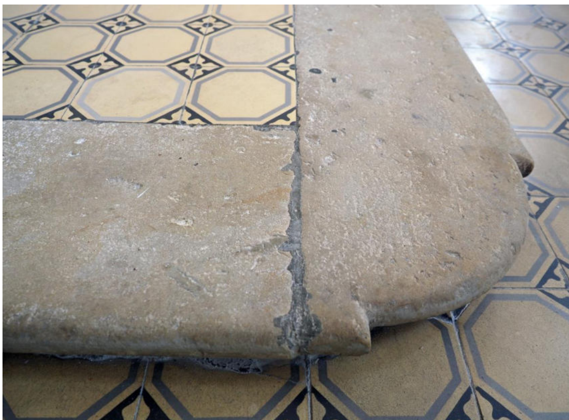
Obr.7. Typická poškození: nevhodné spárování tvrdou šedou cementovou maltou.
