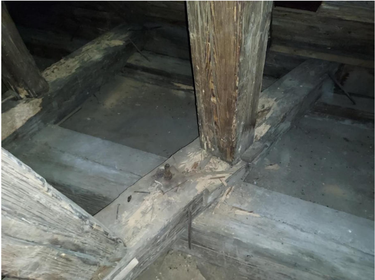
Městská věž, Komenského náměstí (dřevokaznými škůdci napadené dřevěné konstrukce věže)
