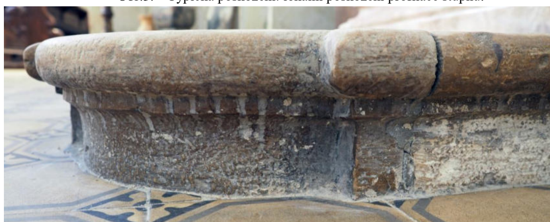
Obr.4. Typická poškození: detail nástupnice schodu, druhotné dožilé hnědé nátěry, spárování provedené nevhodnou tvrdou šedou cementovou maltou a znečištění usazenými depozity.
