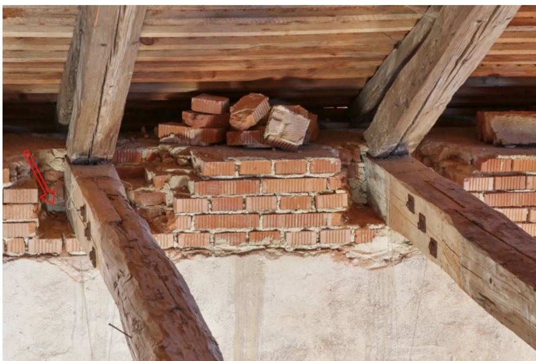
26. Detail odsekání zhlaví vazných trámů. Šípkou vyznačena poloha zcela zazděné pozednice, instalované pod vaznými trámy
