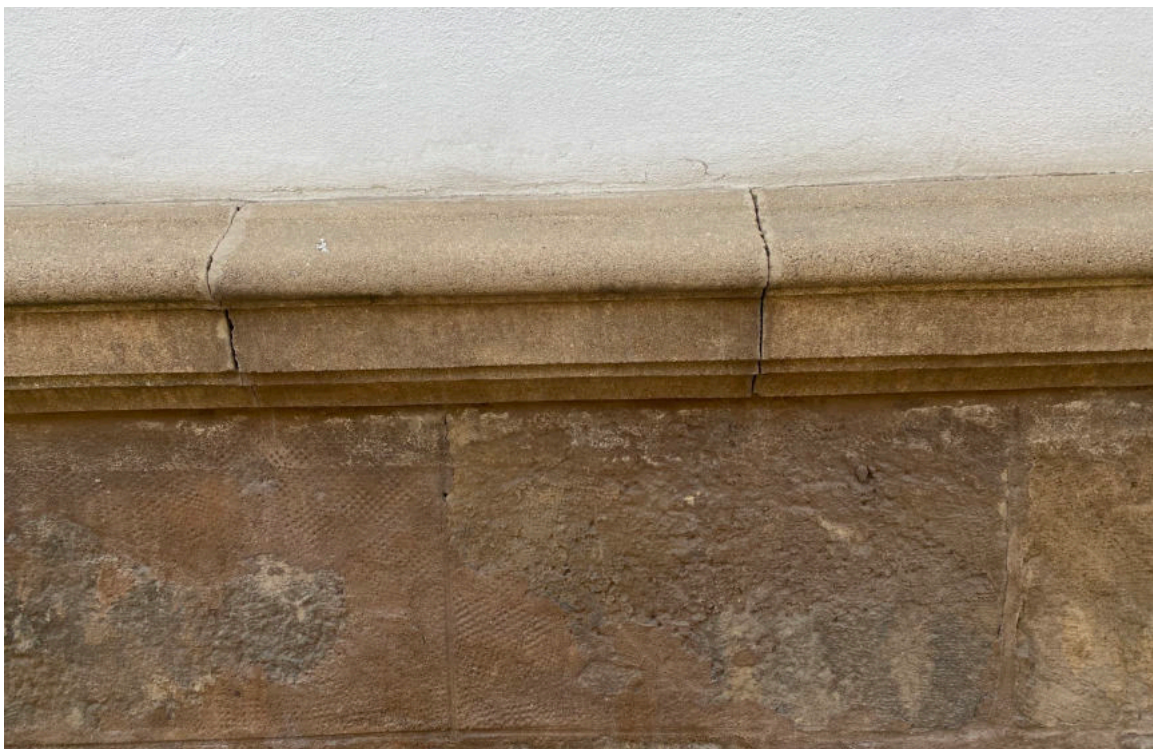
Nahoře vysunutá kamenné desky. Dole chybějící spárování průběžné římsy.
