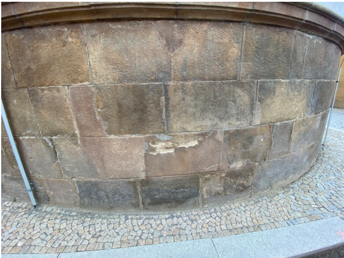
Nahoře viditelně oddělené tvarové doplňky do kterých zatéká voda. Dole obloukovité zakončení sakristie. Dožilé tvarové doplňky, vypadané části a praskliny ve spárování.
