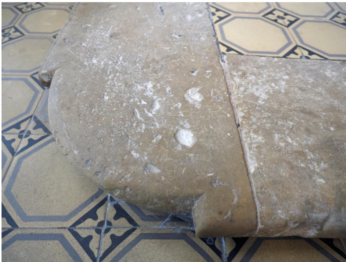
Obr.6. Typická poškození: lokální menší poškození ploch postupnic a porušené spárování.
