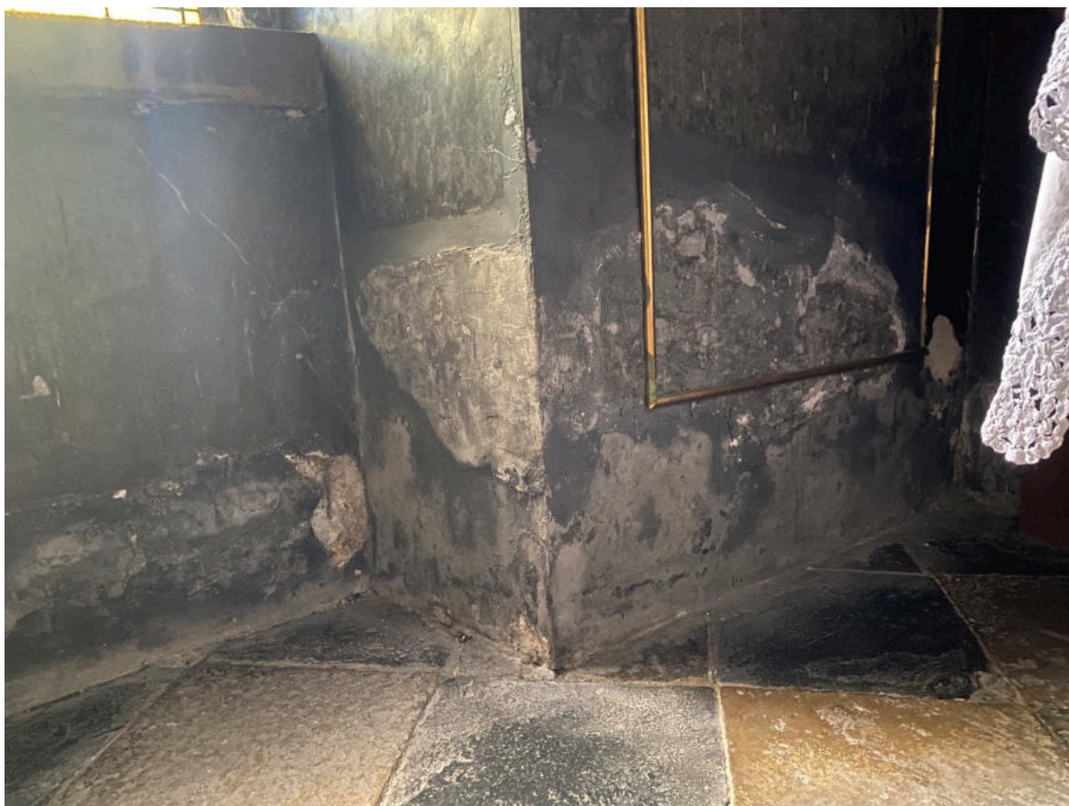
Levá strana s poškozenou spodní částí. Nahoře výklenek s oknem.
