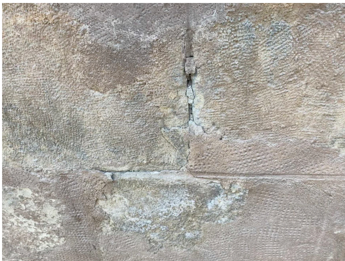
Nahoře vypadané spárování s tmavými tvarovými doplňky. Dole detail chybějícího spárování a odtržení tvarového doplňku od kamene.
