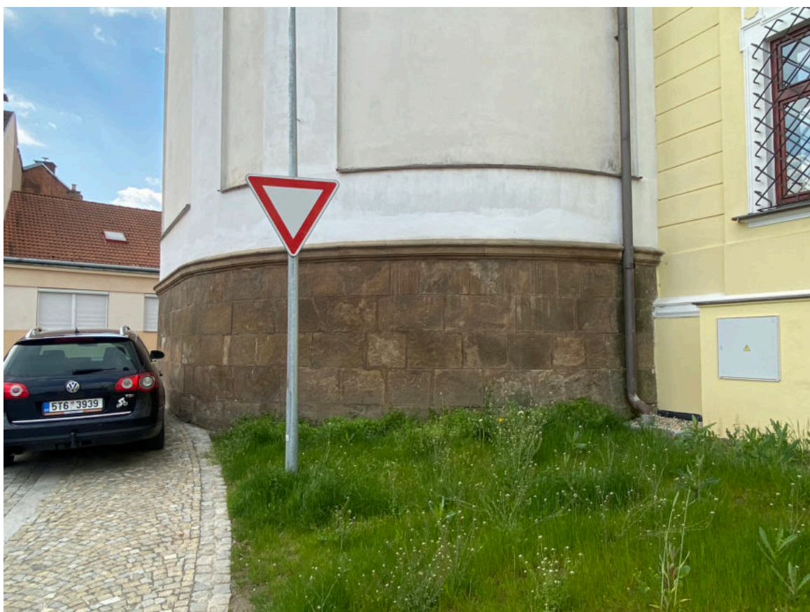
Nahoře detail 3. svodu s viditelnou poruchou odvodu srážek. Zde již trhlina v korunní římsce a do hloubky opadaná profilace římsy kolem svodu. Dole zaústění do systému dešťové kanalizace a pohled na zadní část podezdívky.
