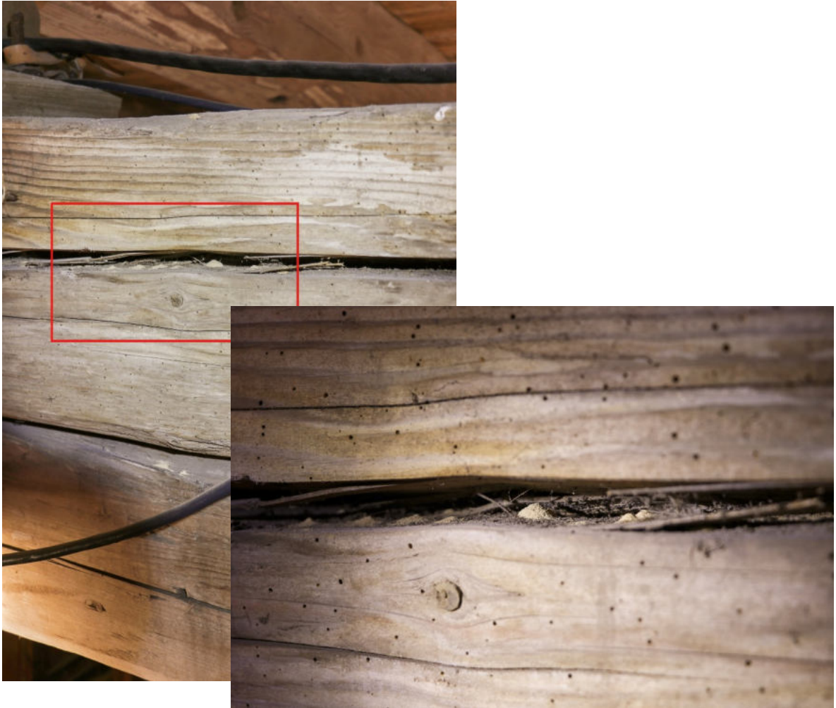
29. Hromádky požerků ve výsušné trhlíně stropního trámu - průkaz aktivity červotoče
