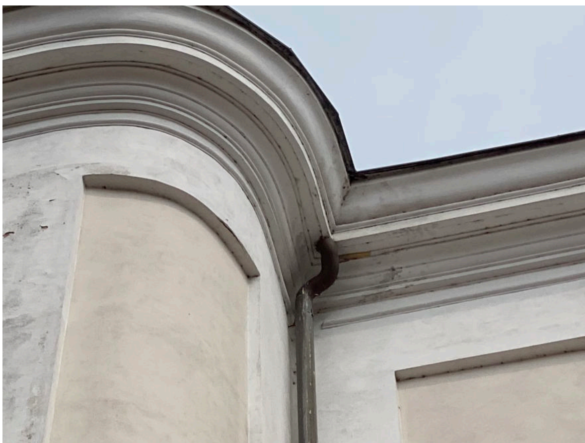
Pohled na 2. svod - odlupující se barva svědčí o vlhkosti omítky.
