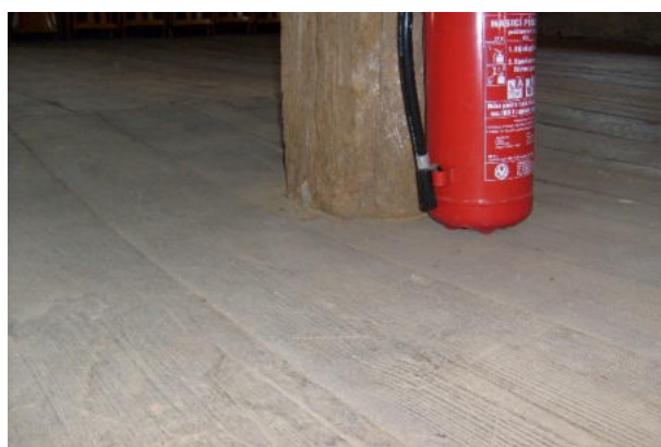
propadená podlahy u sloupu ve 2.NP
