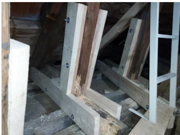
c) zpevnění krovu městské věže:
