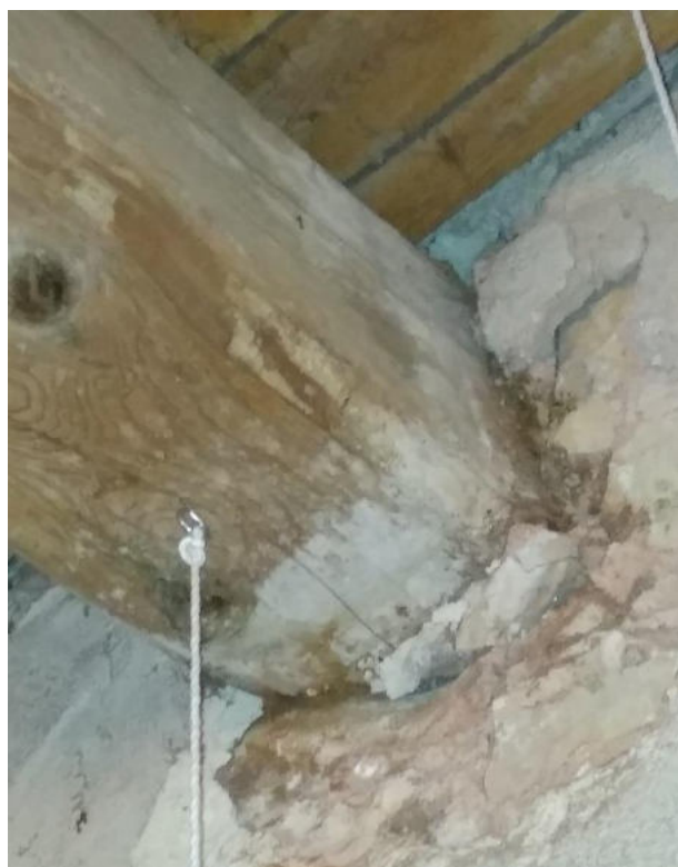
napadené zhlaví stropnic 1.NP
