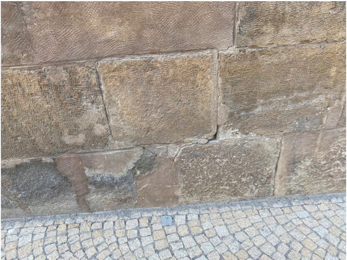
Trhliny způsobené zatékáním vody.
