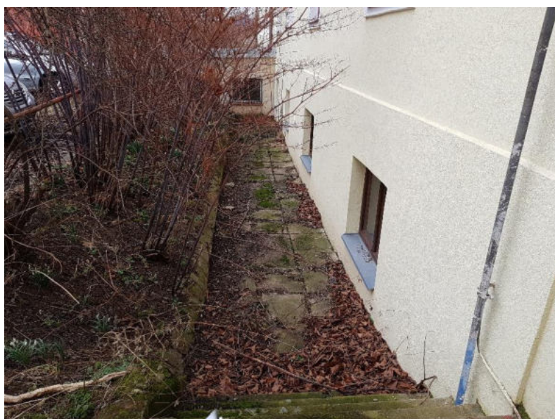
Jižní část západní stěny je do výše 0,2 m pod parapety zahrnuta terénem.
