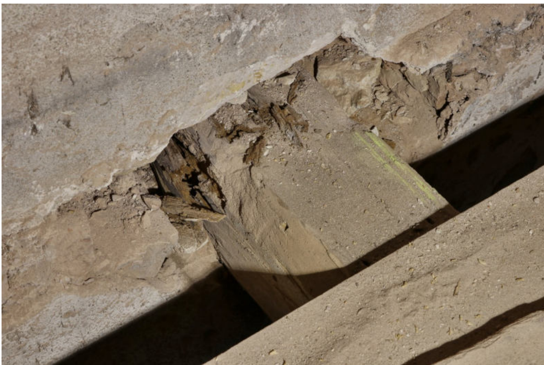
10. Zhlaví stropního trámu nad 1. NP při východní obv. zdi, silně poškozené dřevomorkou a červotočem
