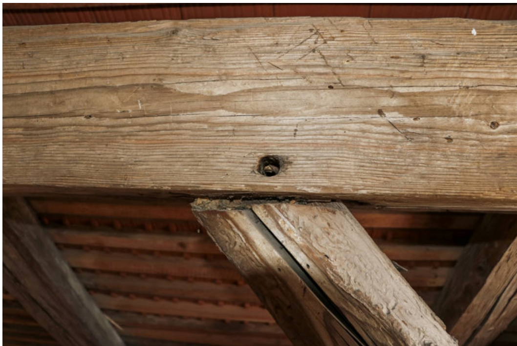
31. Chybějící zajišťovací kolíky čepů pásků v plných vazbách krovu. Čep je částečně uvolněný
