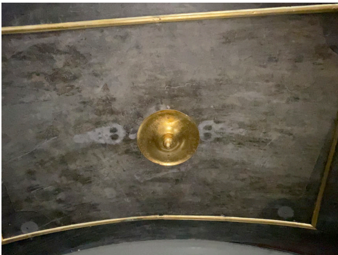
Nahoře část stropní klenby natřená černou barvou. Dole klenba v bočním vstupu se symboly smrti.
