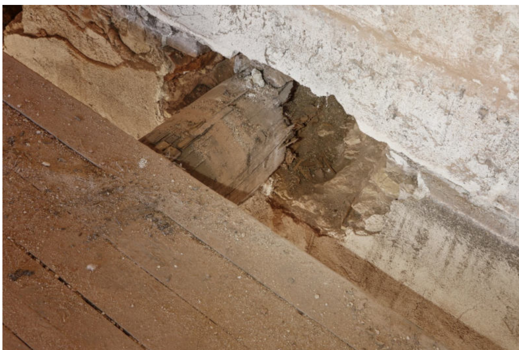
18. Zhlaví stropního trámu nad 2. NP při západní obv. zdi, silně poškozené dřevomorkou a červotočem
