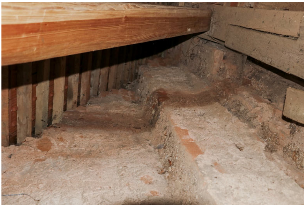
28. Zatékání dešťové vody netěsným oplechováním u jižního štítu
