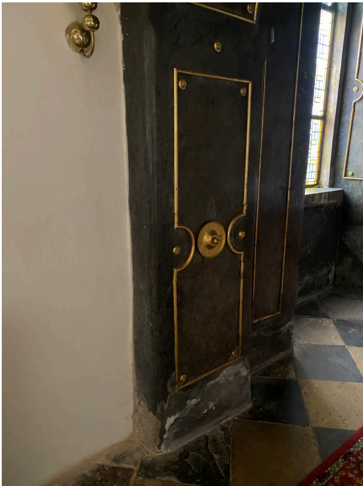
Levá strana s poškozenou spodní částí
