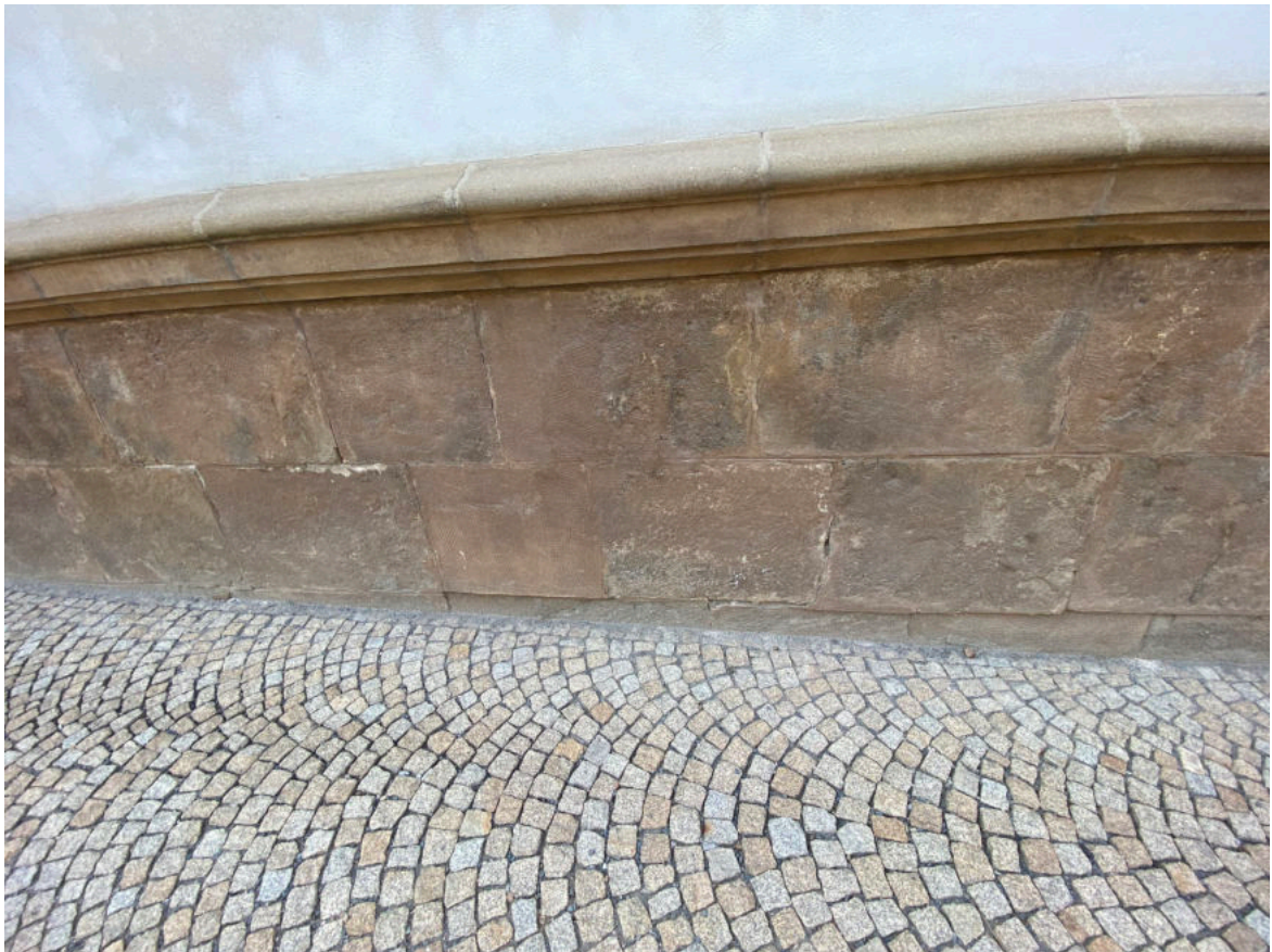
Nahoře trhliny ve spárování. Dole celkový pohled na viditelné tvarové doplňky velkých celků.
