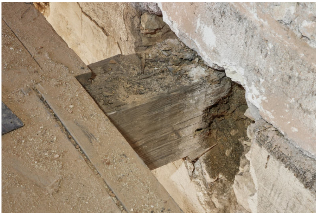
19. Zhlaví stropního trámu nad 2. NP při západní obv. zdi, silně poškozené dřevomorkou a červotočem
