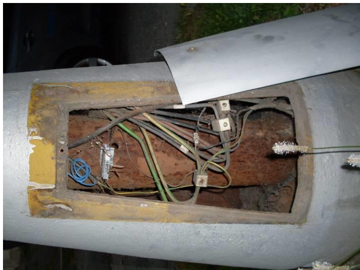
Obr. 8: Silná koroze paty stožáru, lámací svorkovnice
