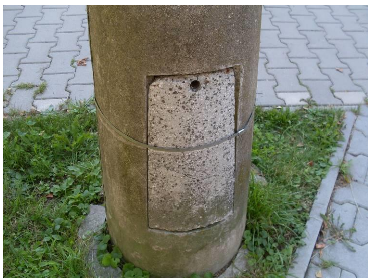
Obr. 11: Improvizované zajištění krytu svorkovnic před laickou veřejností
