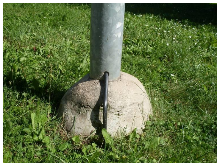
Obr. 18: Vyvedení kabelu z paty stožáru
