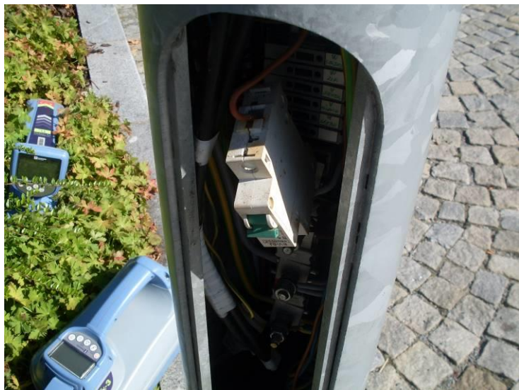
Obr. 19: Volně visící a poškozený jistič svítidla
