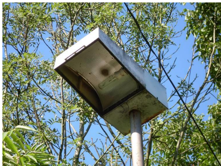
Obr. 14: Chybějící kryt svítidla
