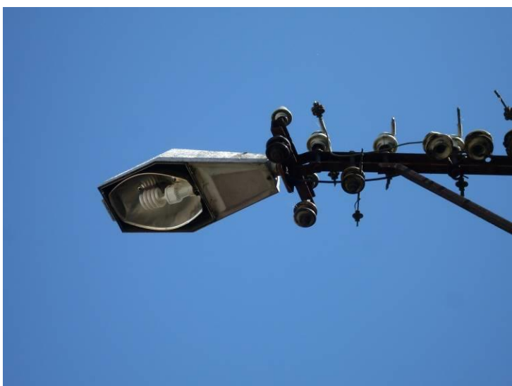
Obr. 15: Chybějící kryt odhalil úspornou výbojku
