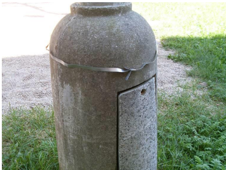
Obr. 12: Nefunkční improvizované zajištění
