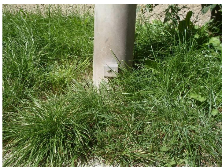
Obr. 17: Chybějící uzemnění stožáru
